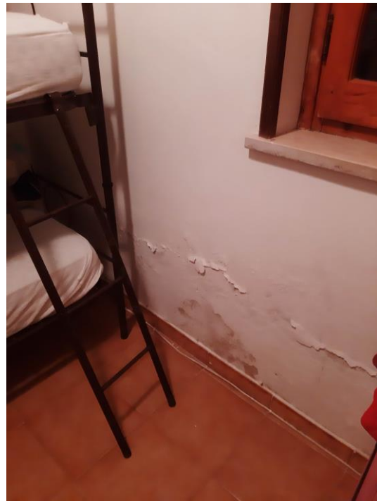
Umidità di risalita
