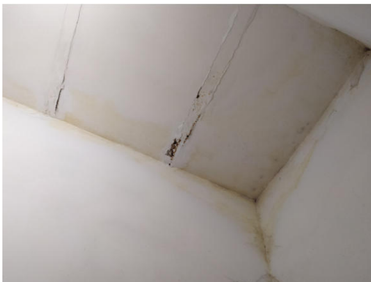
Infiltrazioni soffitto locale ripostiglio
