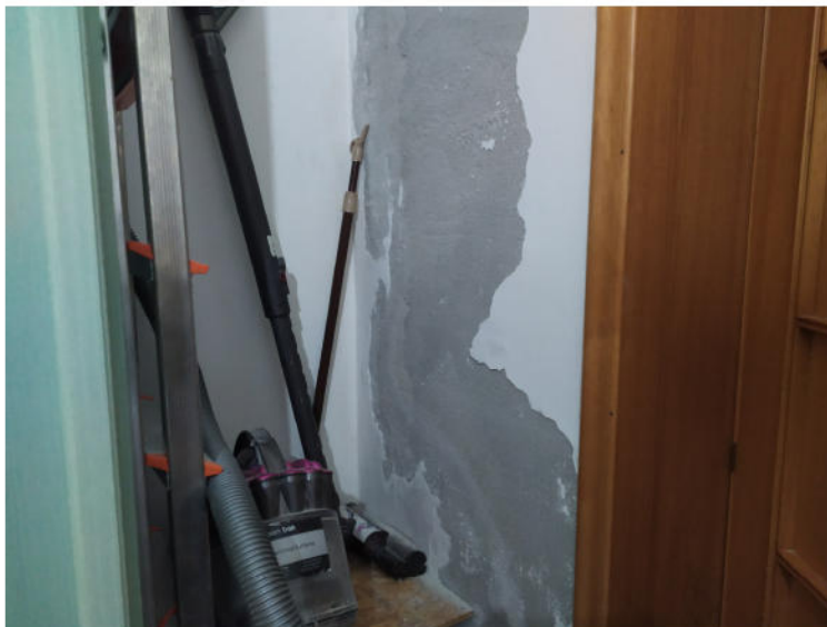
Umidità di risalita
