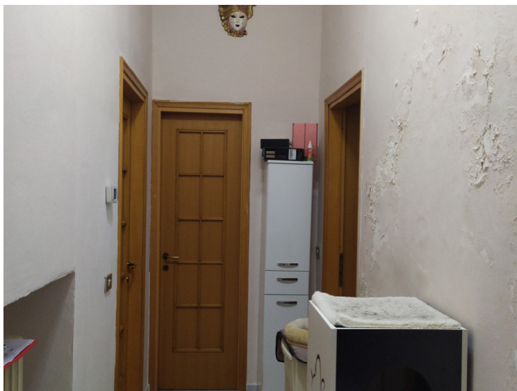
Ingresso con evidenti macchie di umidità
