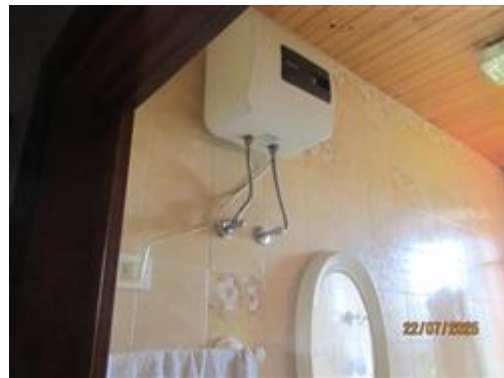
boiler elettrico in bagno
