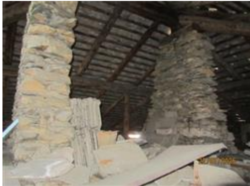
soffitta comune, non esistono scale fisse di accesso
