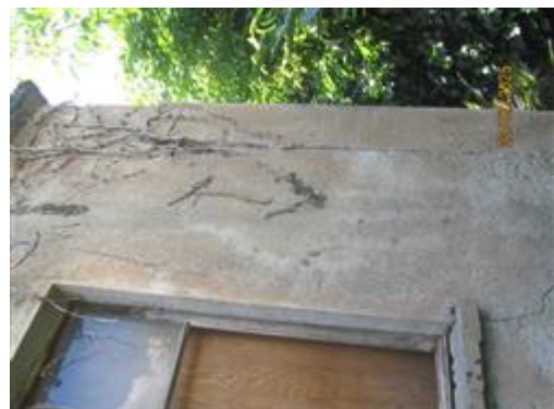
muratura del garage con evidenti fessurazioni (angolo nord)
