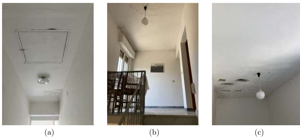
Figura 11: Vista delle varie infiltrazioni presenti sul solaio di copertura (a), (b), (c).
