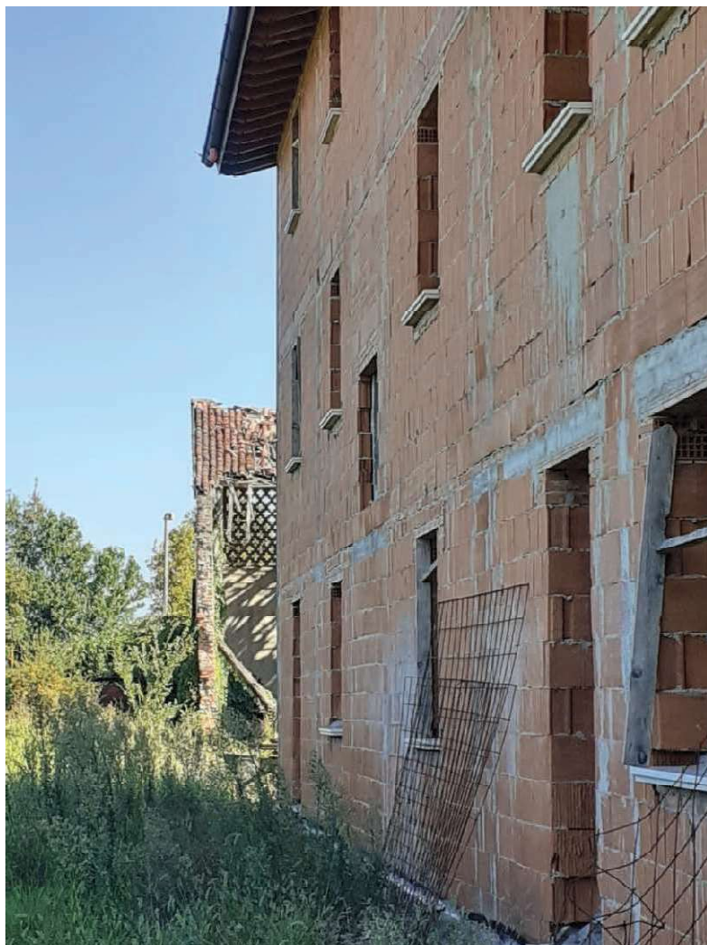
FOTO N 12 Veduta lato ovest mappale 380 sub 3 (non ultimato) e parte crollata
