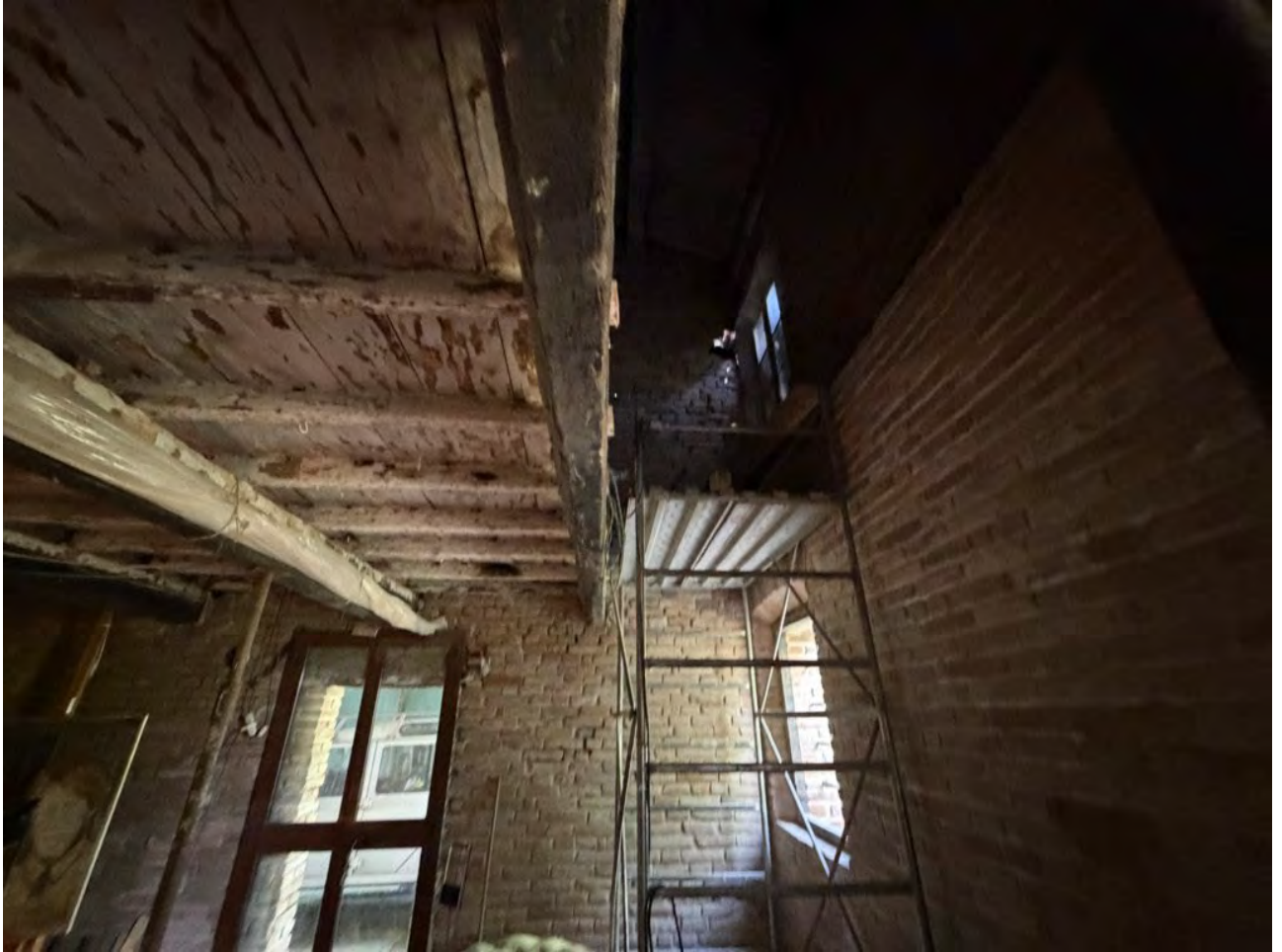
Foto 14. Interno abitazione piano terra. Particolare porzione di solaio mancante
