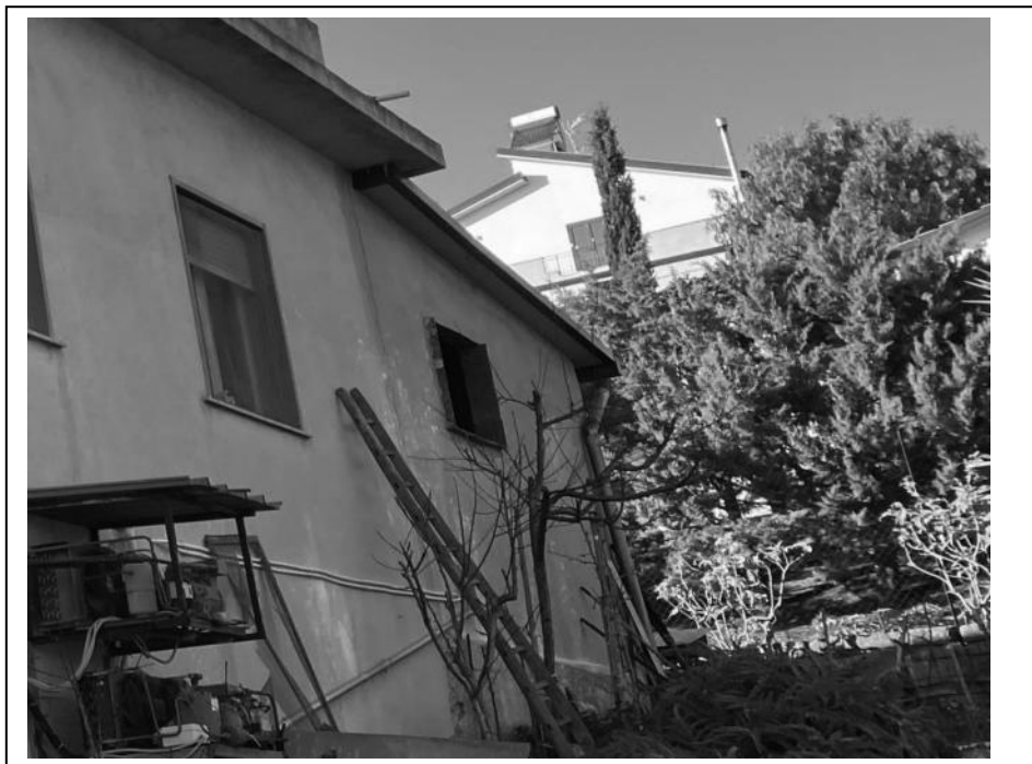
Fotografia n. 9 – Fabbricato – Esterno – struttura abusiva
