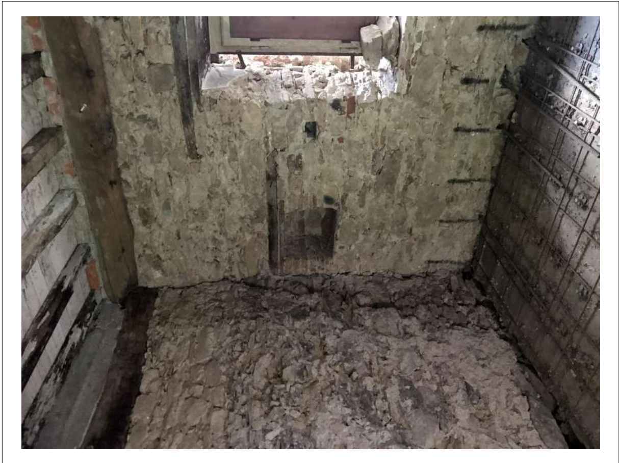
FOTO 31: Piano PRIMO - Vista del vano principale (Camera) verso la finestra posta sul fronte principale.
