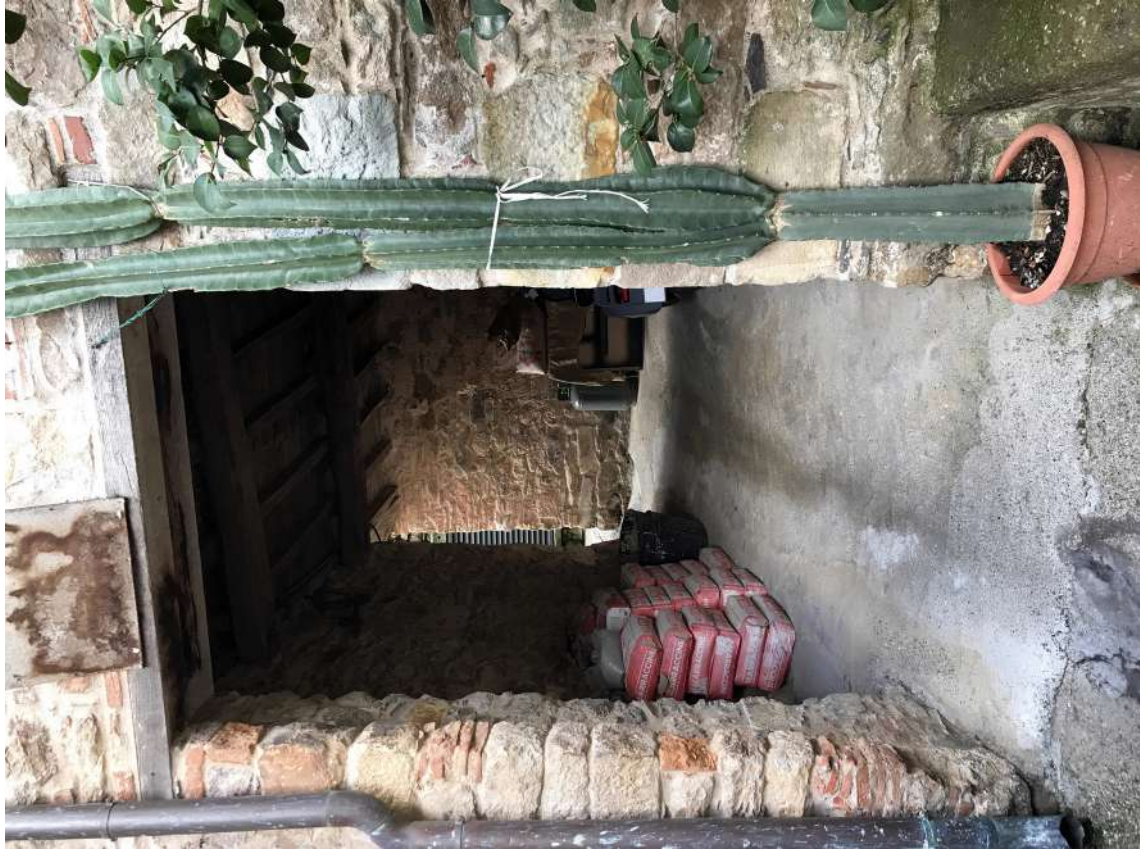
FOTO 9: Sottopassaggio con accesso all'Unità Immobiliare in oggetto (Piano Seminterrato) Passaggio di proprietà esclusiva soggetto a transito di altre Proprietà.
