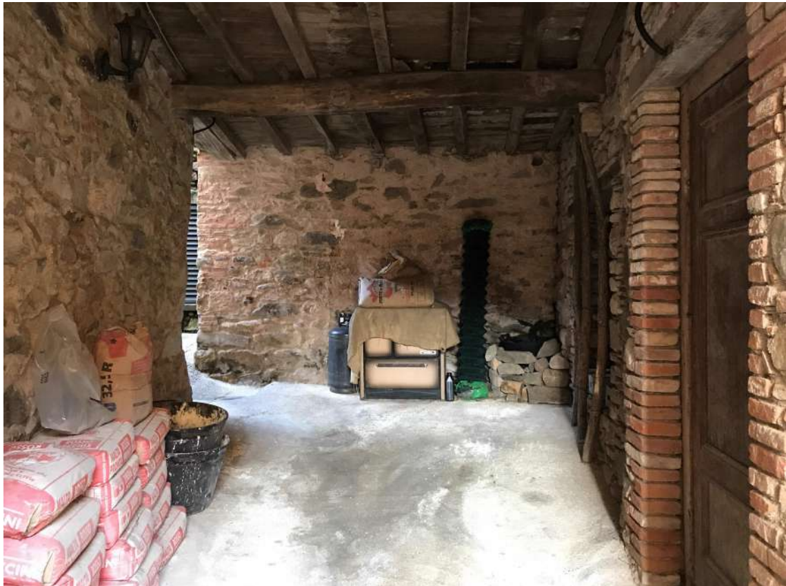
FOTO 10: Dettaglio di quanto alla foto precedente - A Dx porta di accesso al Piano Seminterrato.
