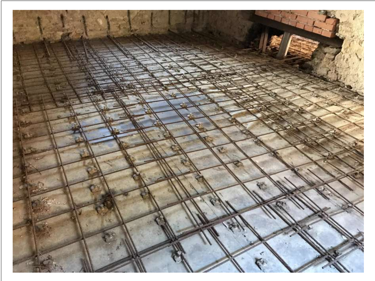
FOTO 35: Piano PRIMO - Dettaglio intervento al solaio nel vano principale - Rete elettrosaldata collegata con connettori metallici ai sottostanti travicelli.
