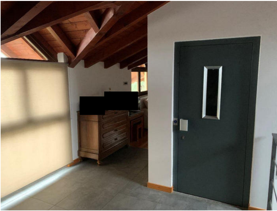
09 ascensore interno sbarco al piano secondo
