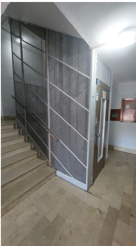
Foto n.7: Impianto ascensore (funzionante)
