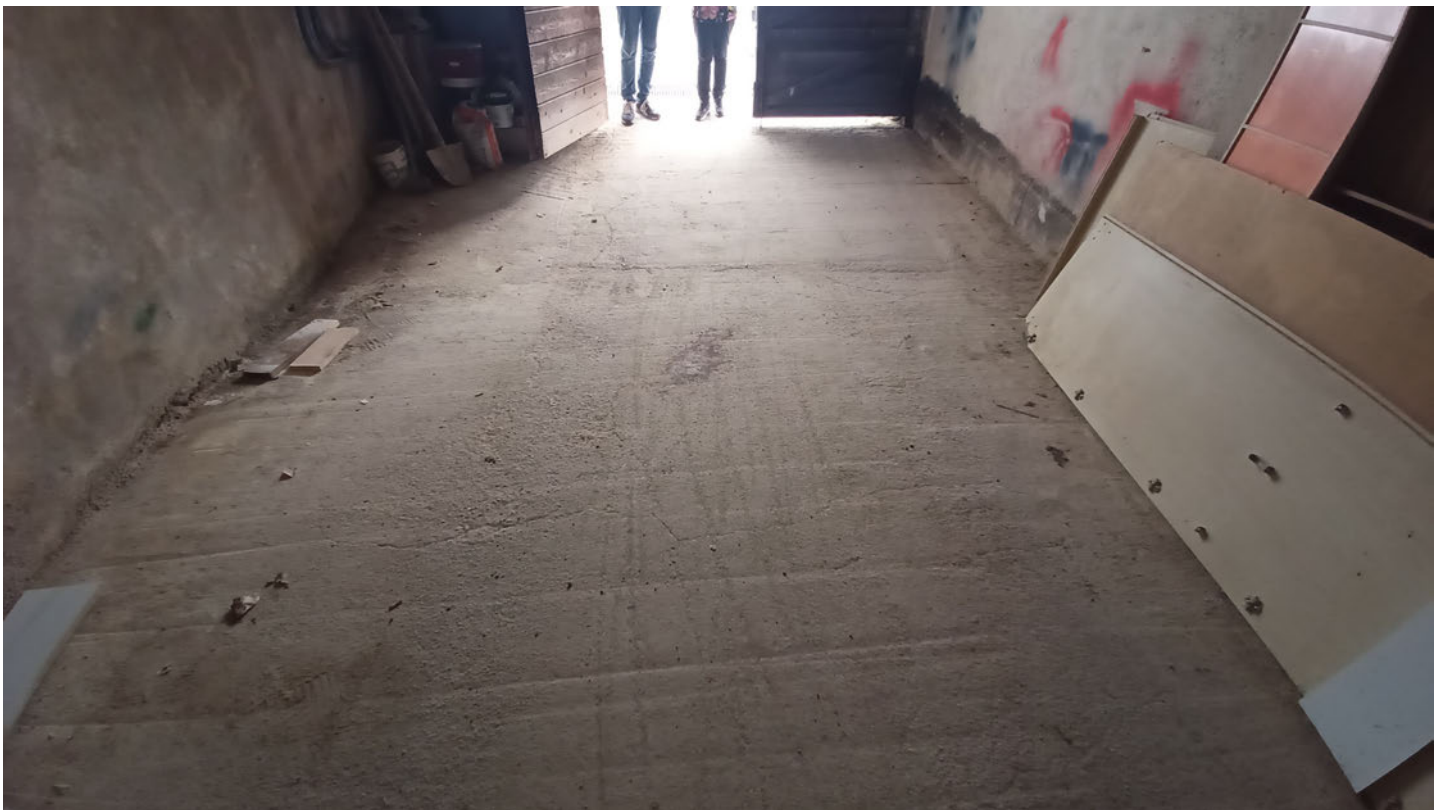
Foto n. 4. Integrazione alla CTU. Comune di Pozzuoli - Via Cuma di Licola n°152. Causa R.G.E. 241/2017. Interni. Vista dall'interno verso la parete esterna dell'ingresso. Particolare del solaio pavimento. Stato dei luoghi ritratto al 24 settembre 2025 durante
