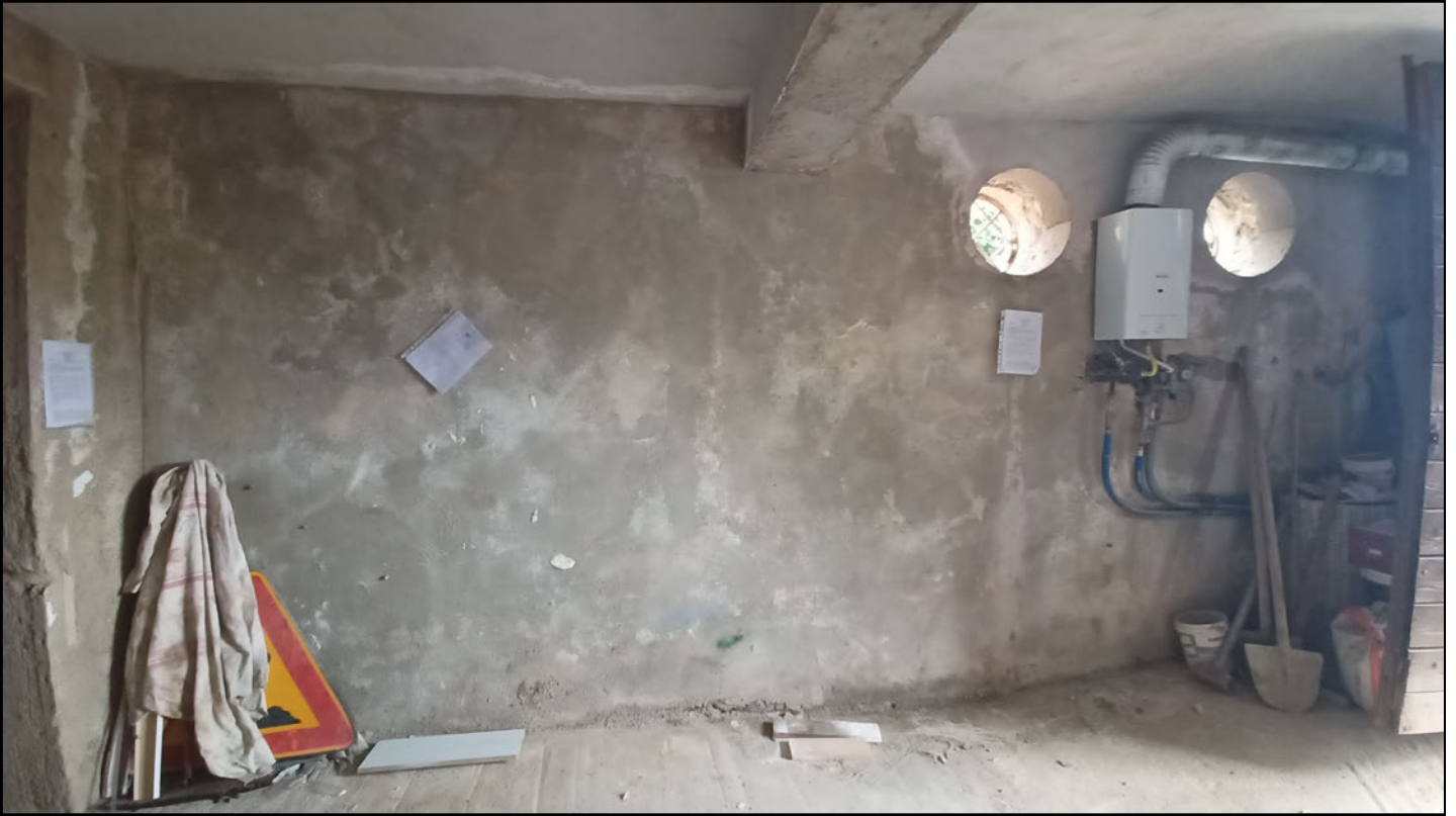
Foto n. 3. Integrazione alla CTU. Comune di Pozzuoli - Via Cuma di Licola n°152. Causa R.G.E. 241/2017. Interni. Vista dall'interno verso la parete NordEst. Sono visibili le due finestre tipo oblò, che forniscono luce naturale e aerazione al locale Stato dei luoghi ritratto al 24 settembre 2025 durante il sopralluogo.
