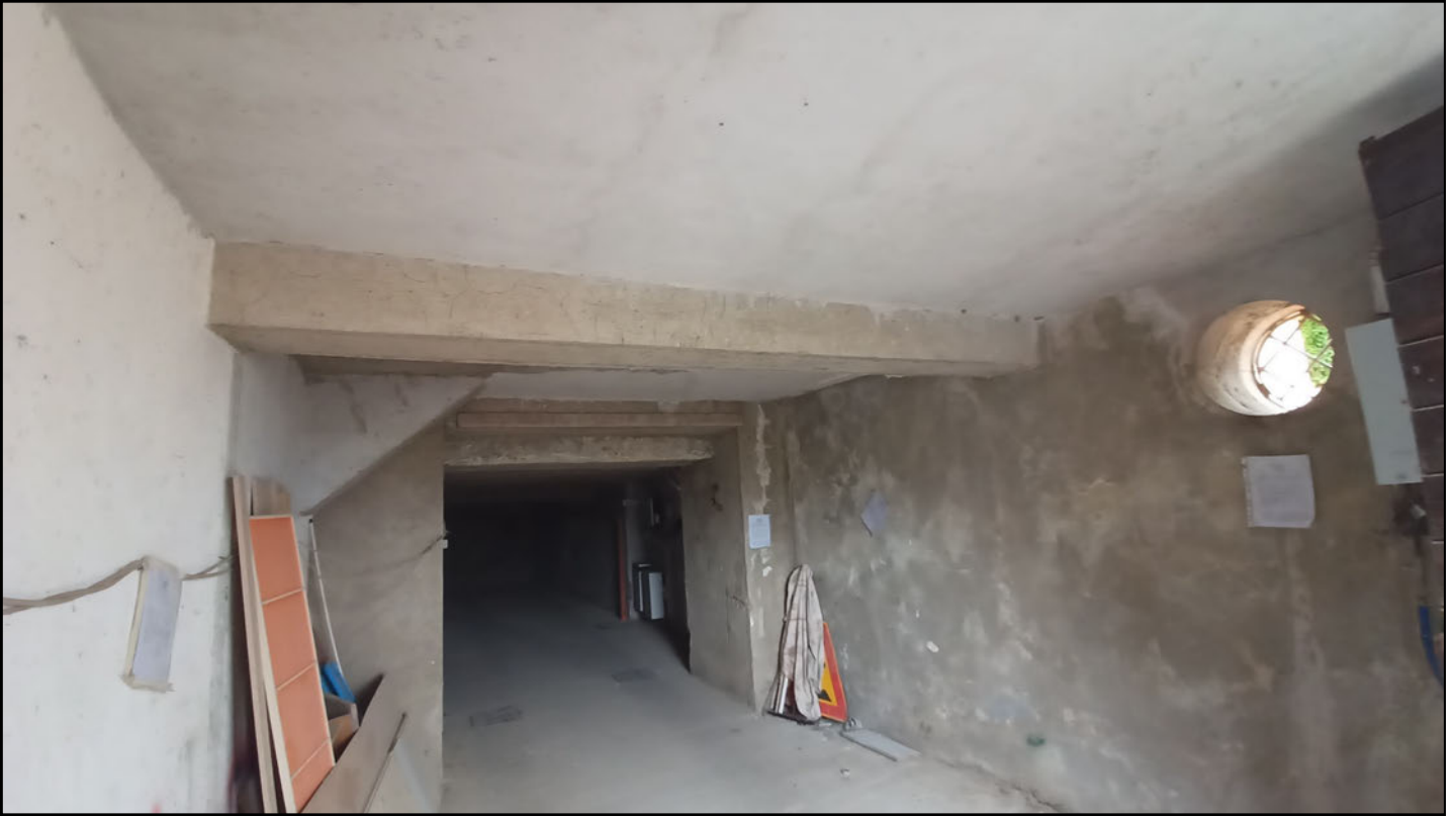
Foto n. 1. Integrazione alla CTU. Comune di Pozzuoli - Via Cuma di Licola n°152. Causa R.G.E. 241/2017. Interni. Vista dalla strada pubblica dell'interno dell'immobile garage-deposito. In fondo è visibile il varco verso proprietà aliena non inclusa nella procedura di esecuzione immobiliare. Stato dei luoghi ritratto al 24 settembre 2025 durante il sopralluogo.
