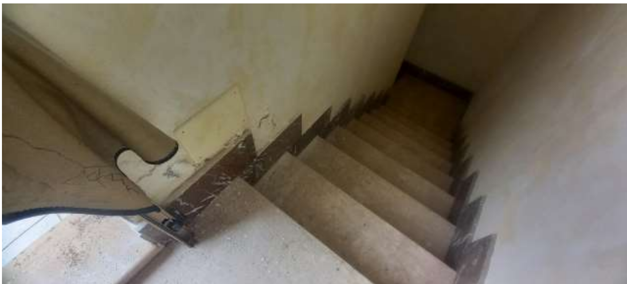
Foto 20 – Immobile “1A” – Umidità al I P
