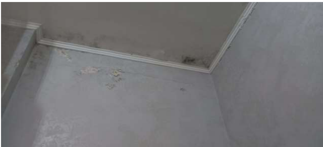
Foto 21 – Immobile “1A” – Umidità al P.T.
