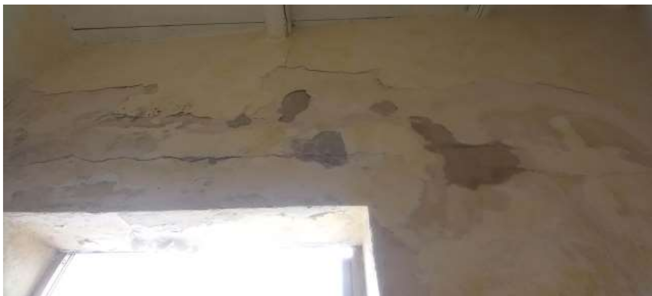
Foto 19 – Immobile “1A” – Umidità al I P
