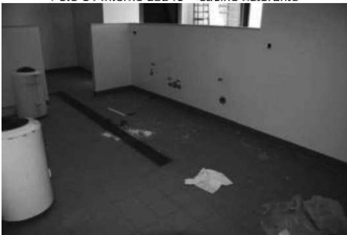
Foto 86 Interno sub40 – cucine ristorante
