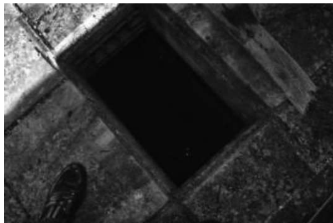
Foto 117 Botola cisterna sulla sub38 Area pavimentata per la raccolta acque
