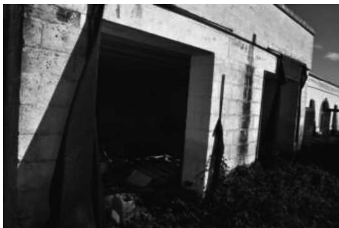
Foto 116 Locale tecnico retrostante acquario sub38
