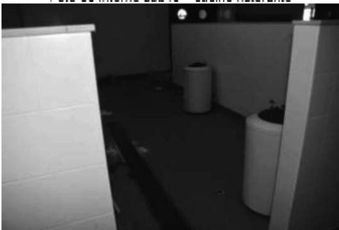
Foto 88 Interno sub 40 – cucine ristorante
