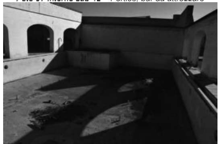
Foto 99 Sub42 – Piscina scoperta
