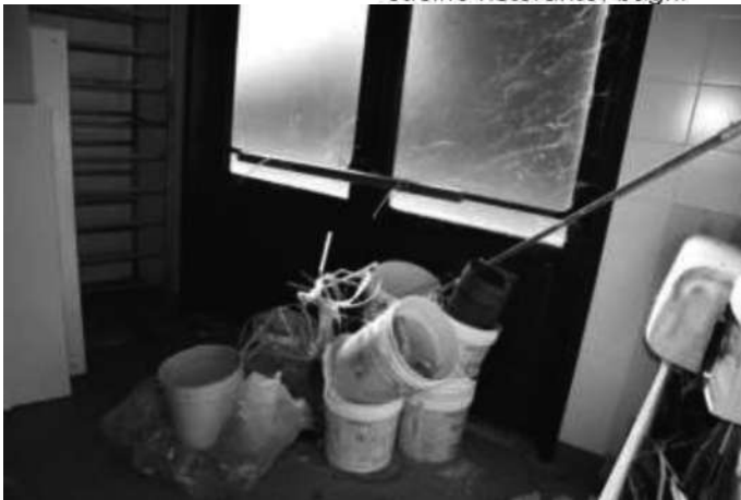
Foto 94 Interno sub 40 – cucine ristorante
