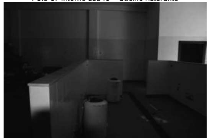
Foto 89 Interno sub 40 – cucine ristorante
