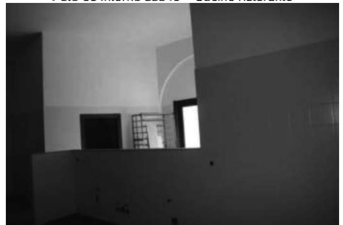
Foto 87 Interno sub40 – Cucine ristorante
