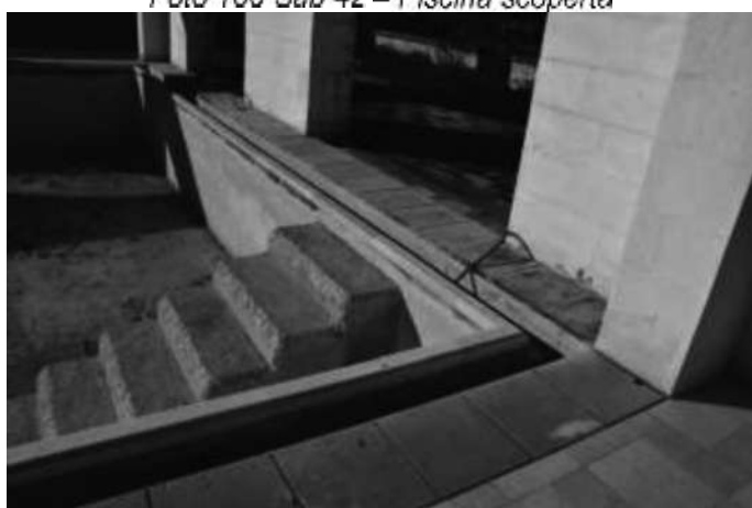
Foto 102 Sub 42 – Piscina scoperta
