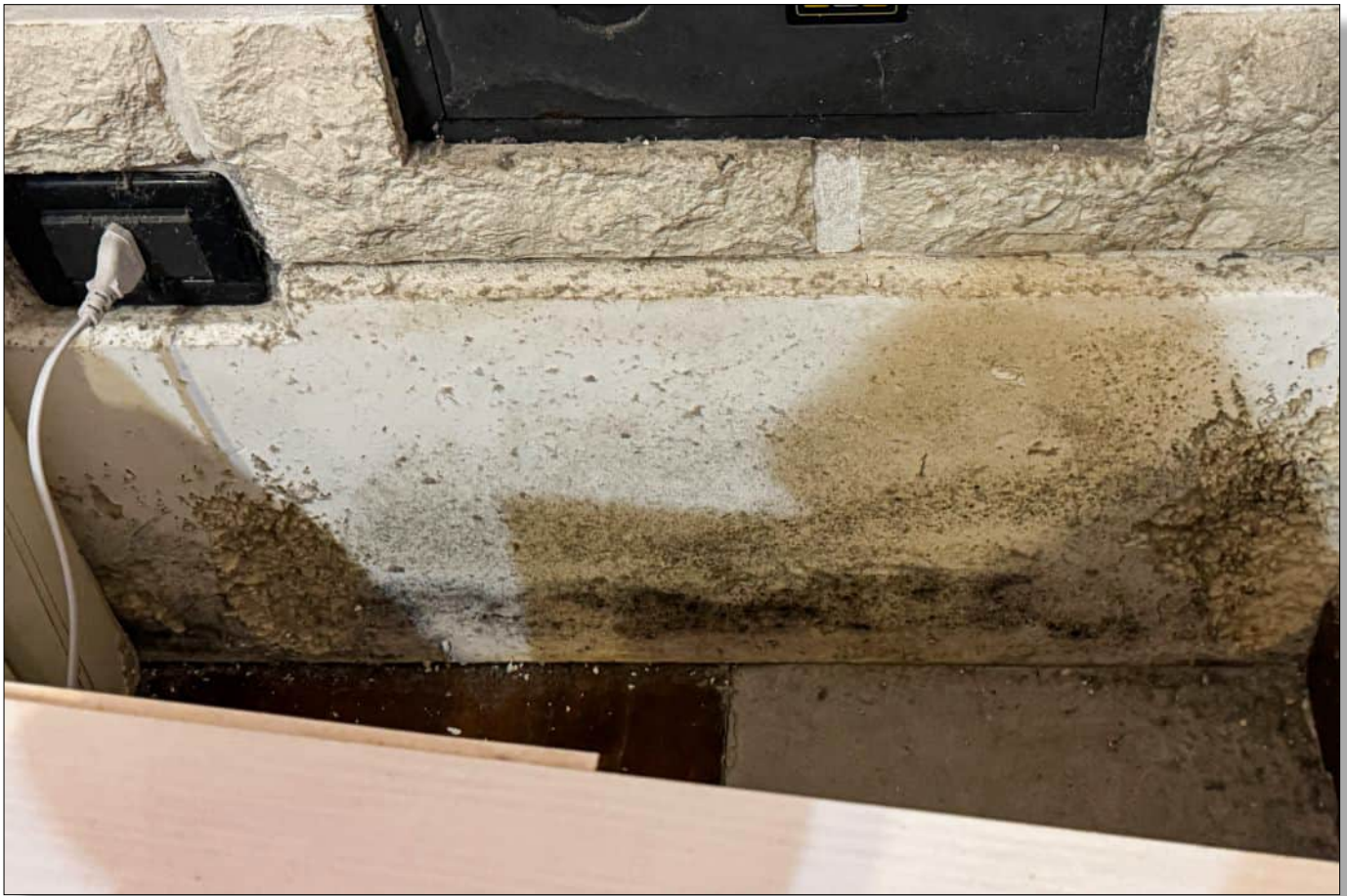
Foto n. 17) Sfarinamento parete angolo sud/ovest
