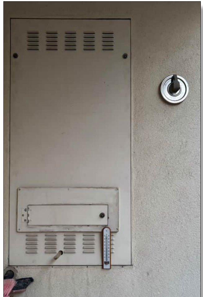
Foto n. 19) Caldaia esterna lato est
