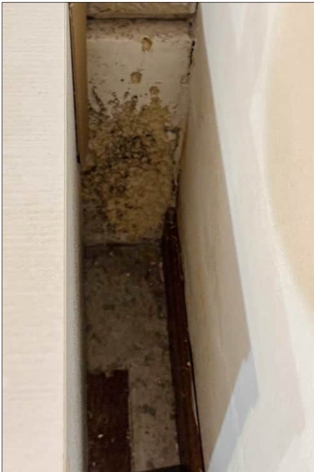
Foto n. 18) Sfarinamento parete angolo sud/ovest
