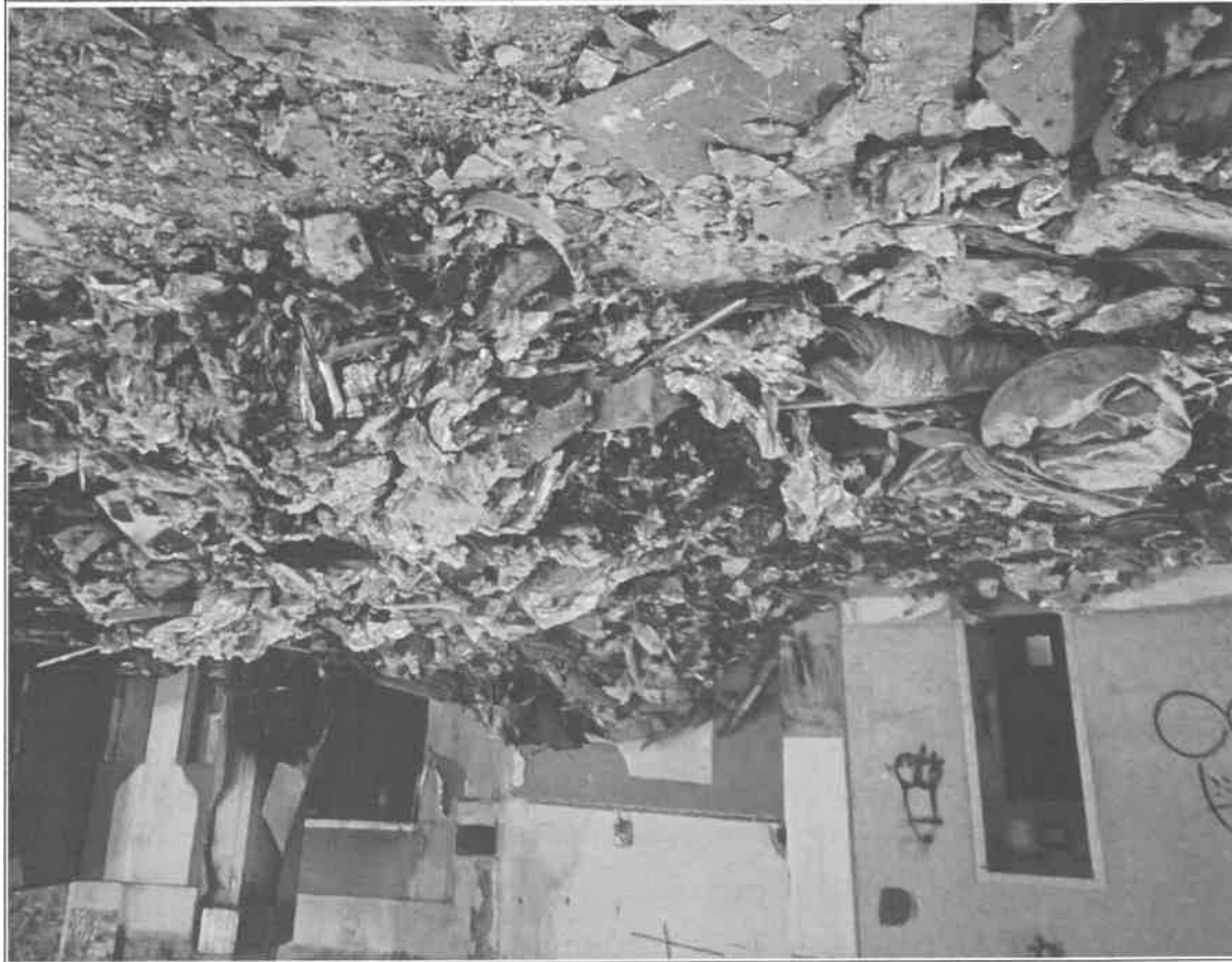
Foto n°07: Fibre vetrose dopo l'incendio con residui carboniosi in superficie
