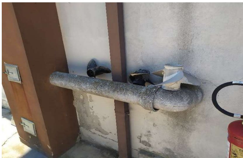
FOTO N. 16: tubo di amianto da smaltire posto sulla parete dell'abitazione – LOTTO N. 2
