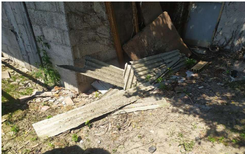
FOTO N. 15: lastre di amianto da smaltire sul retro del capannone – LOTTO N. 2
