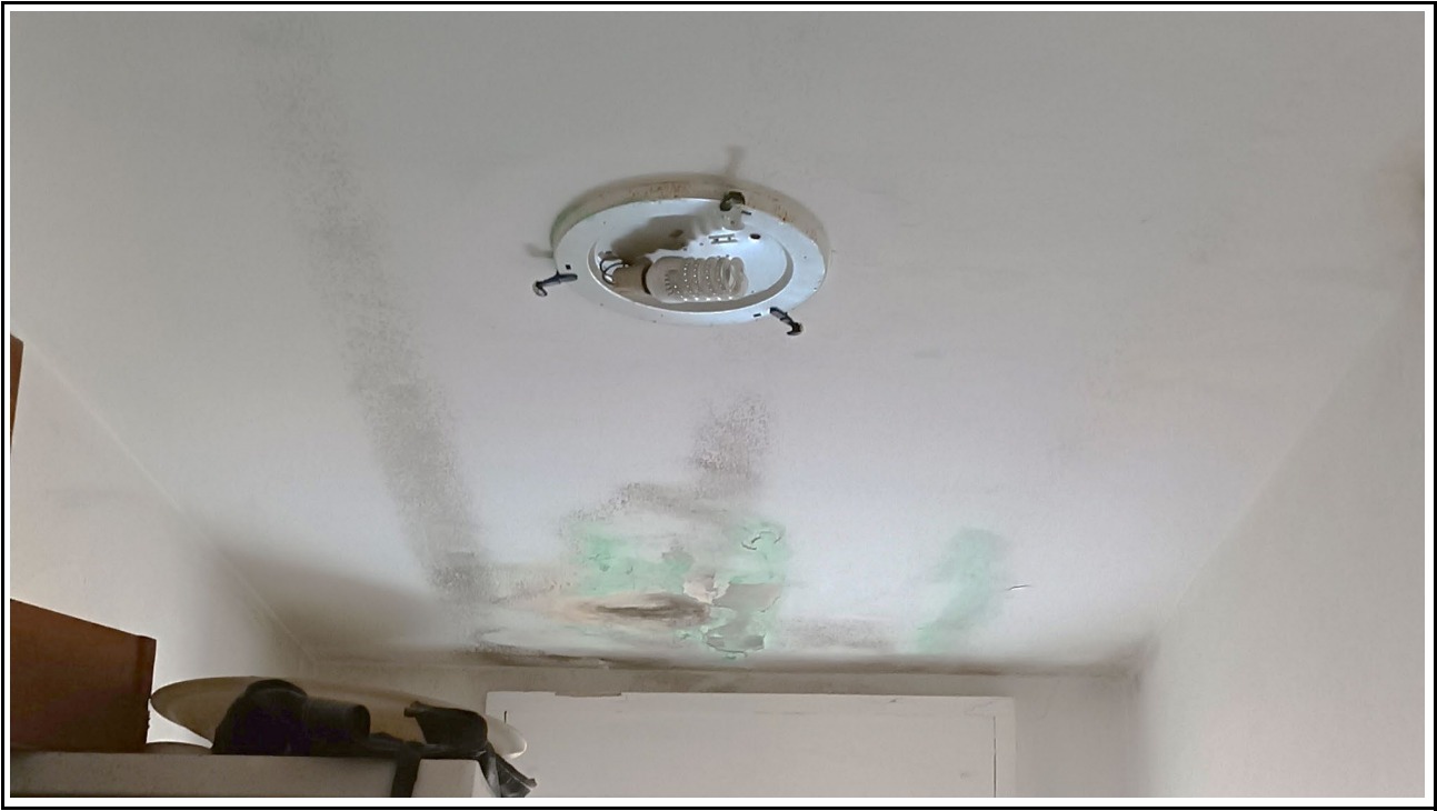
Foto n°23 - Bagno: infiltrazione soffitto
