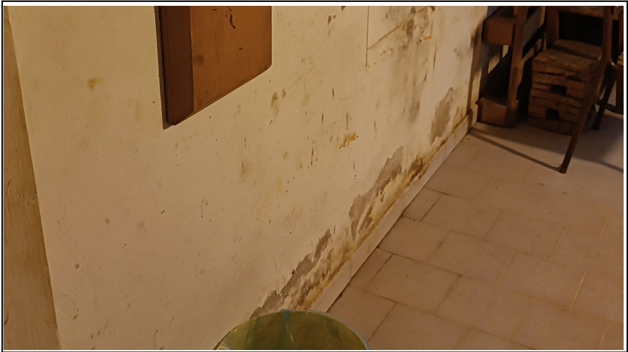
Foto n°27 - Pranzo: infiltrazione dal basso parete
