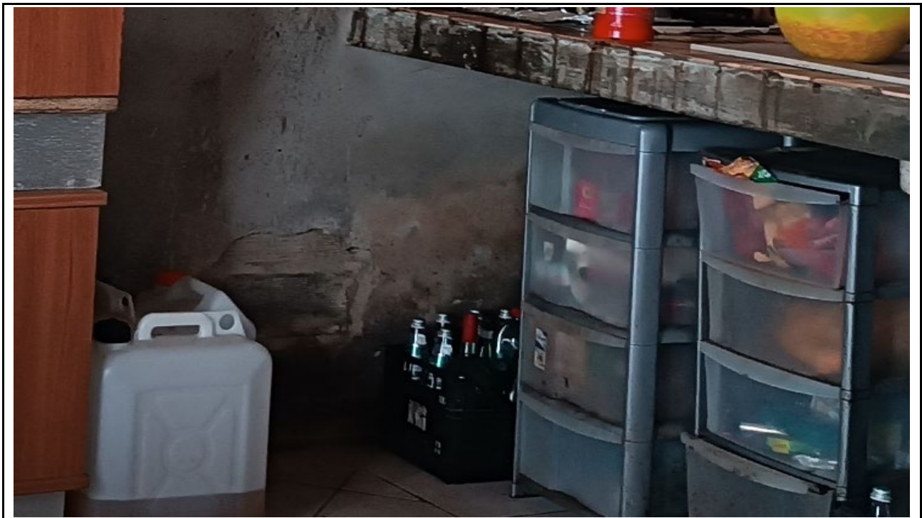
Foto n°28 - Cucina: infiltrazione dal basso parete
