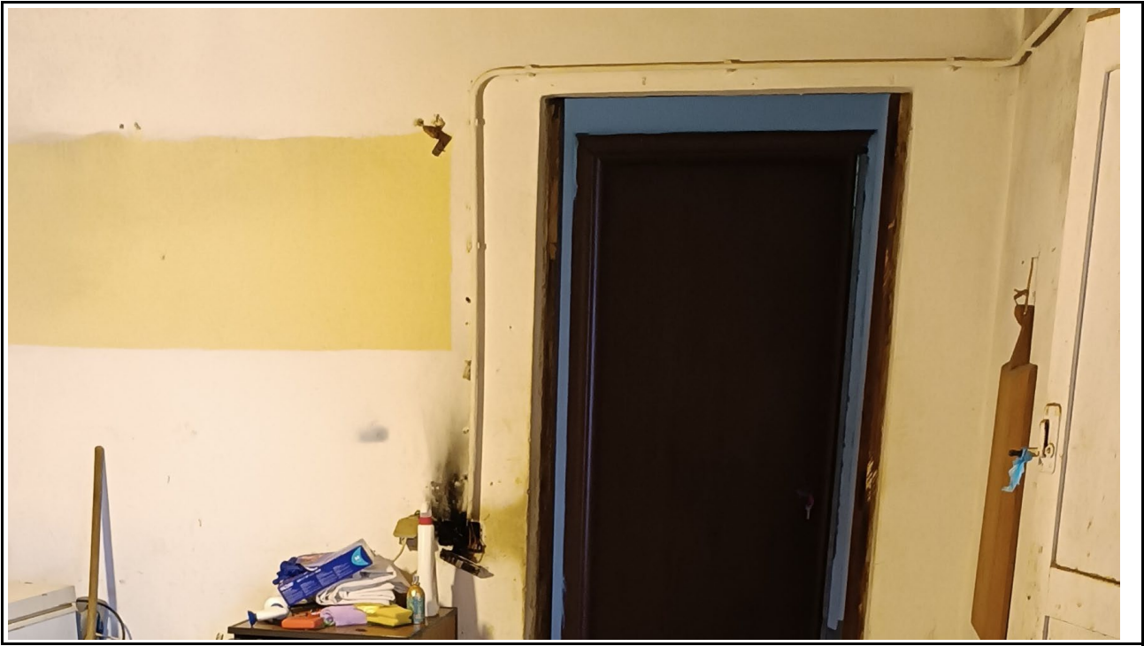
Foto n°37 - Impianto elettrico non a norma
