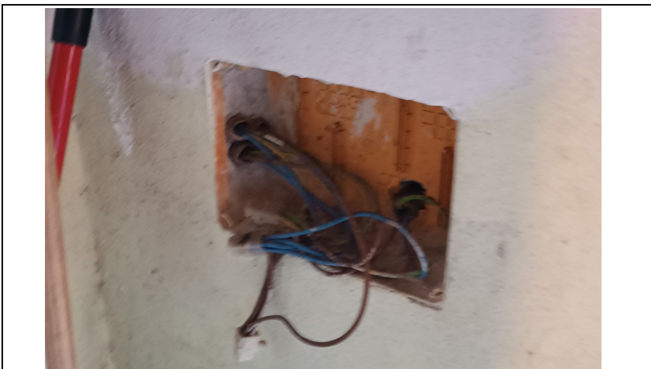
Foto n°34 - Impianto elettrico non a norma
