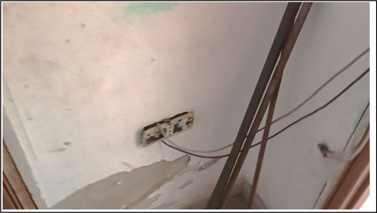
Foto n°35 - Impianto elettrico non a norma
