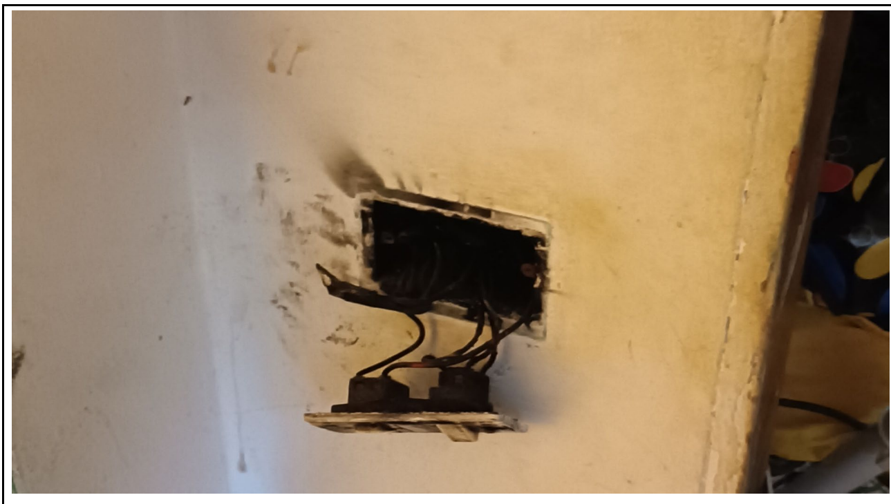
Foto n°33 - Impianto elettrico non a norma
