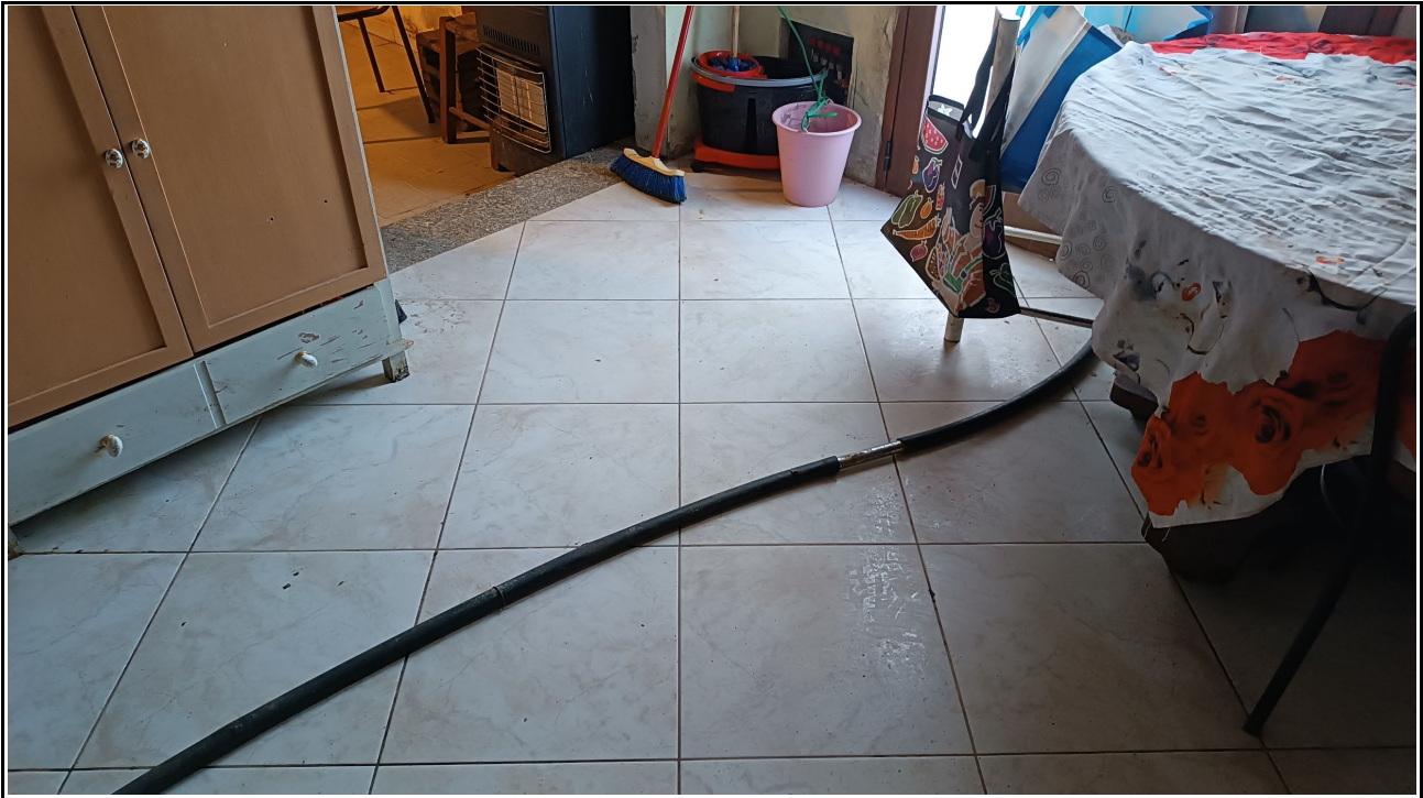
Foto n°32 - Cucina: tubazioni di scarico volanti
