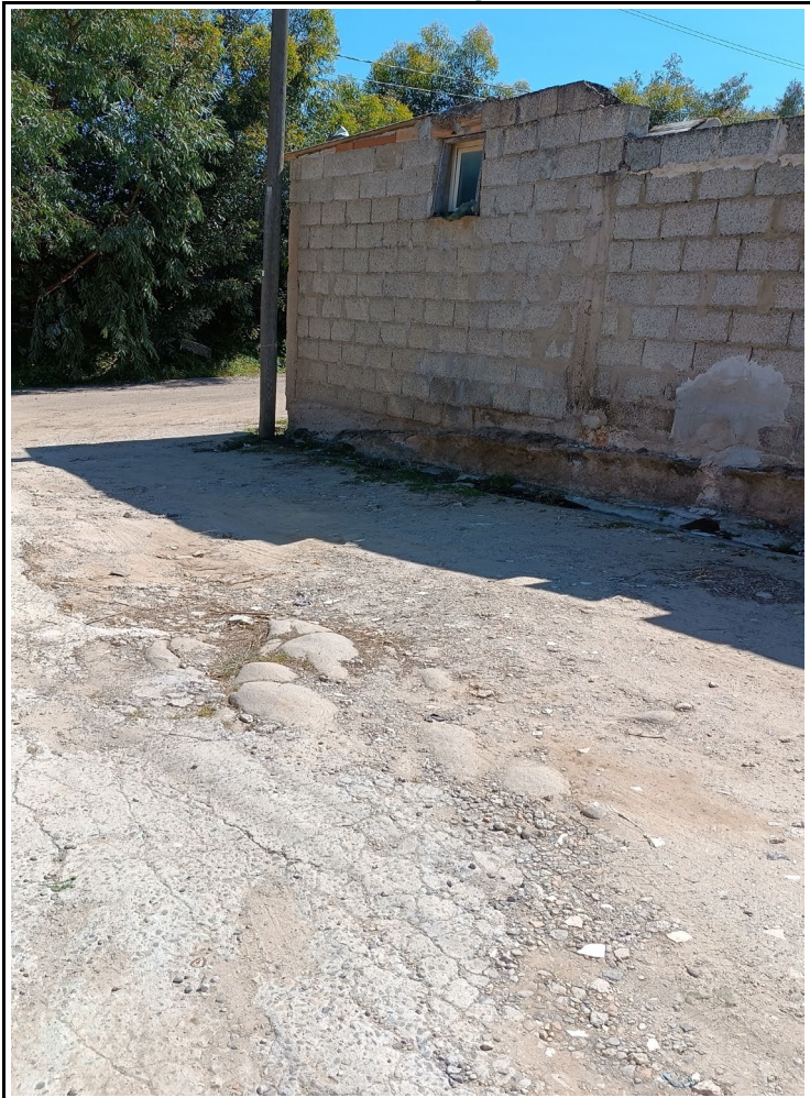
Foto n°4 - Condizioni della via pubblica
