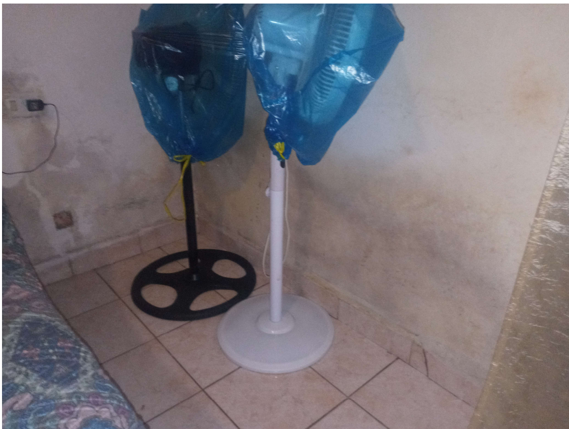
Foto n. 12 - Vista dell'umidità di risalita
