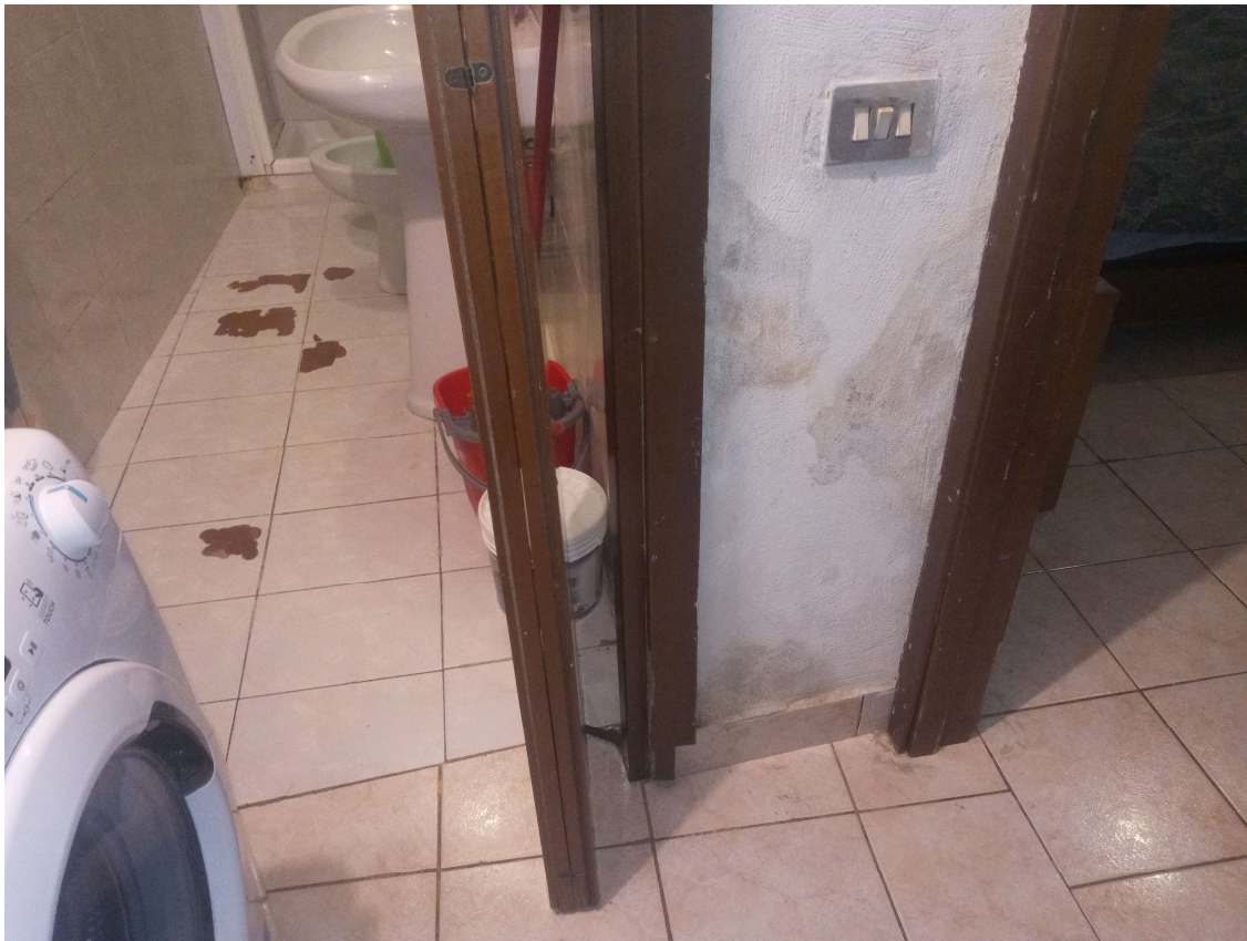
Foto n. 13 - Vista dell'umidità di risalita
