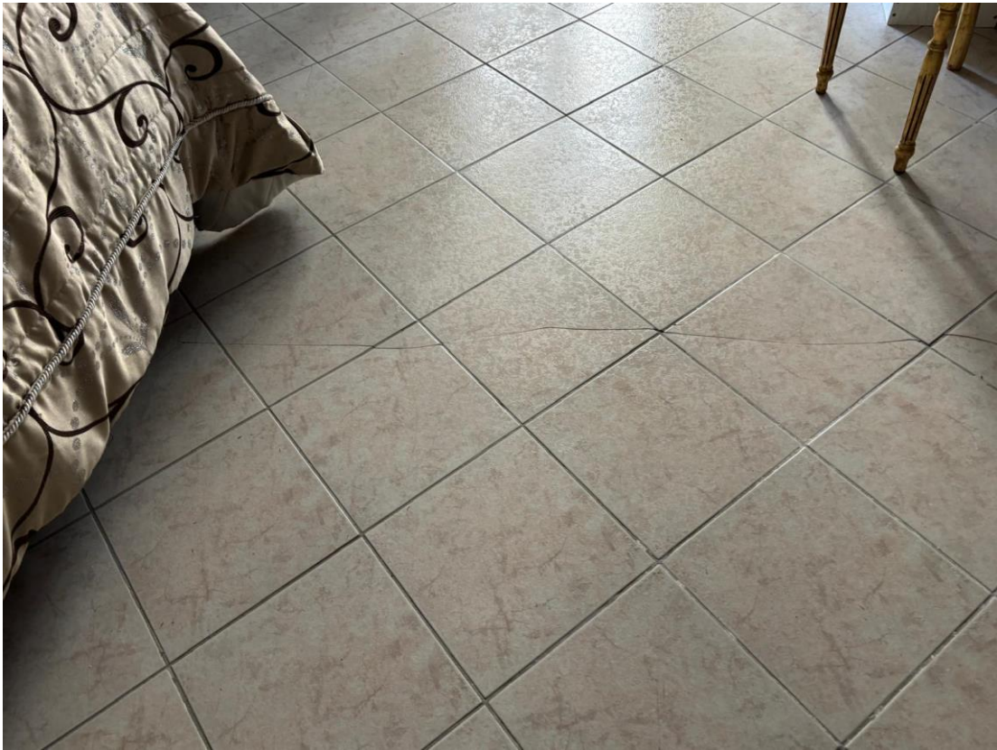
Foto n. 11 – Particolare di alcune lesioni superficiali del pavimento della camera da letto, posta al piano primo dell'unità immobiliare
