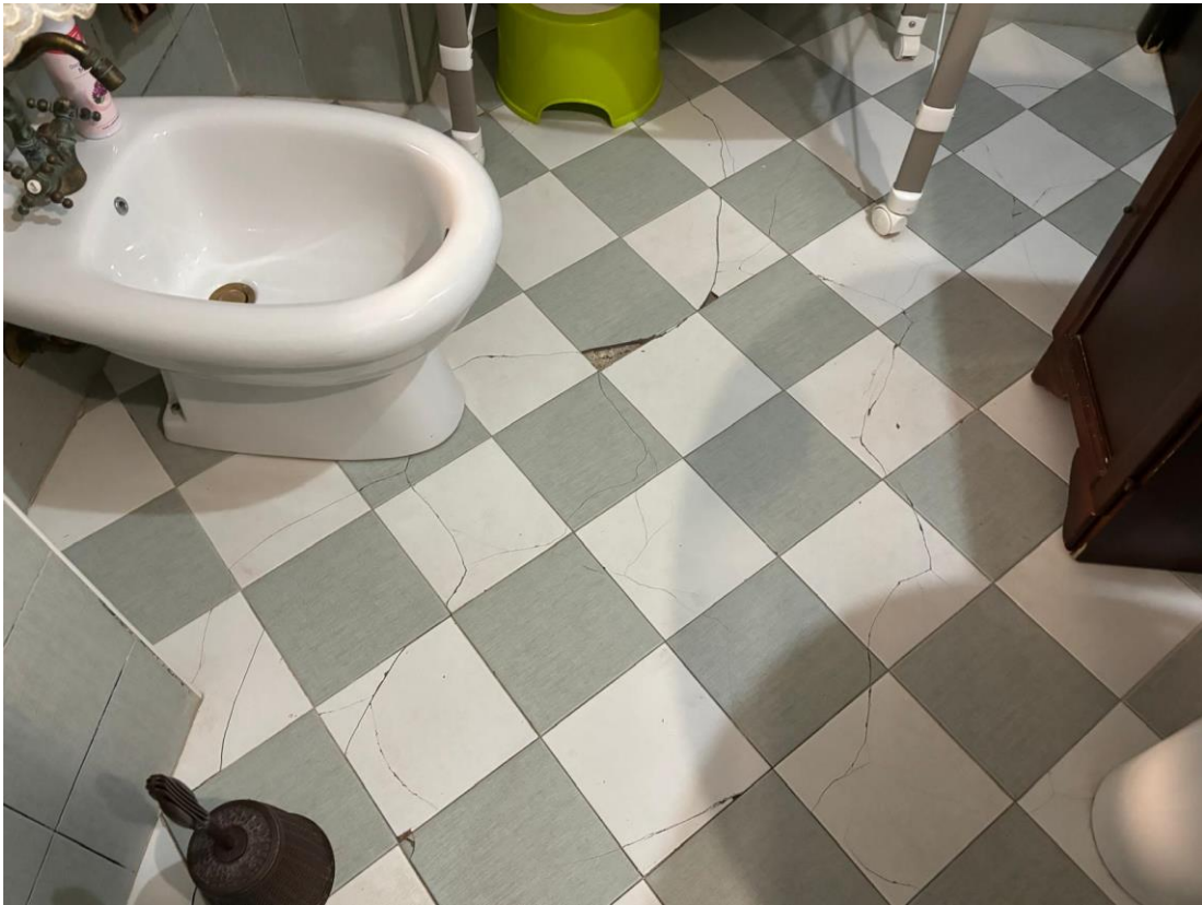
Foto n. 7 – Altra vista del bagno dell'unità immobiliare con il particolare di alcune lesioni superficiali del pavimento
