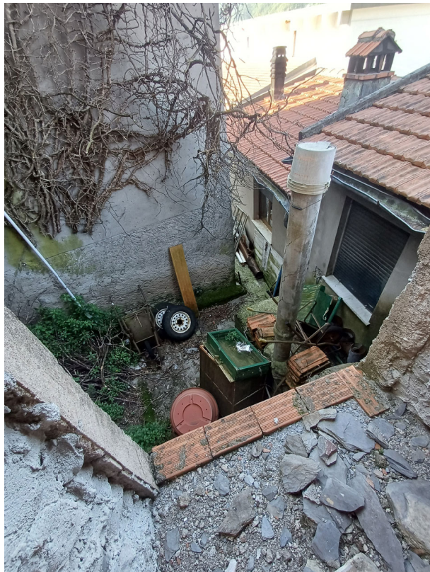
Fotografia n. 12 – vista distacco corte
