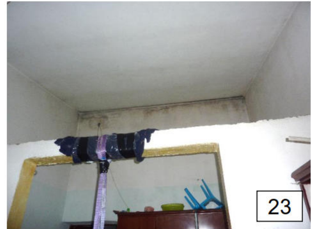
Infiltrazioni (anti bagno)
