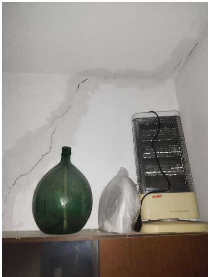
Foto 16) BENE 1 – Unità A – Parete disimpegno (particolare quadro fessurativo)
