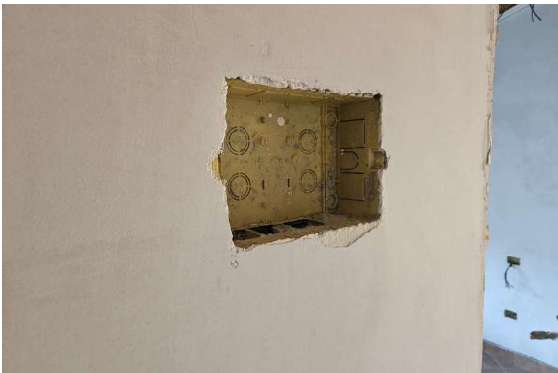
Quadro elettrico generale incompleto
