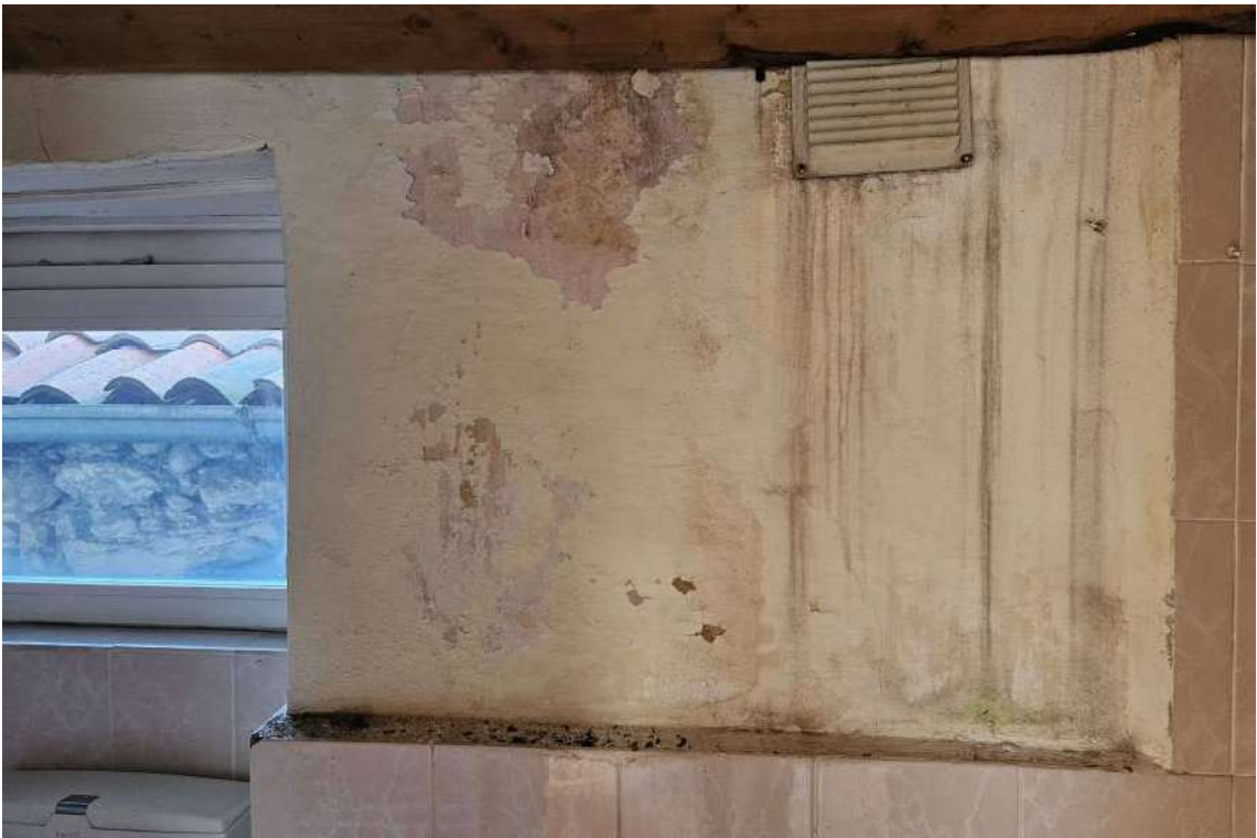
Infiltrazioni nel bagno
