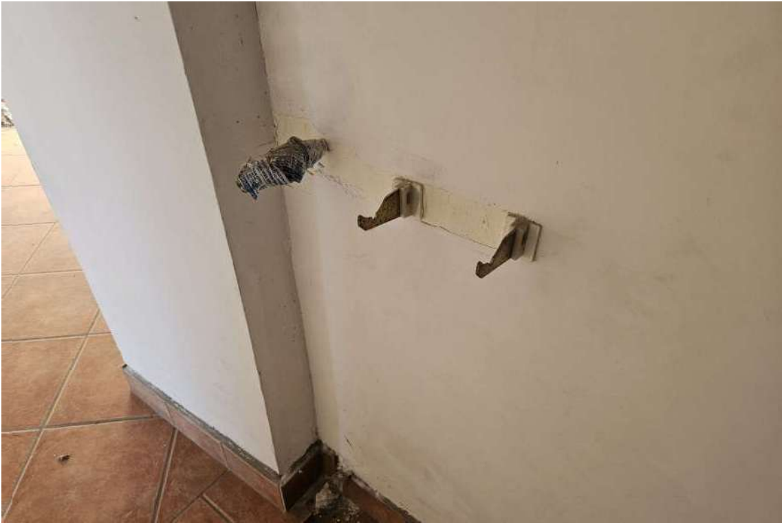
Impianto di riscaldamento senza radiatori
