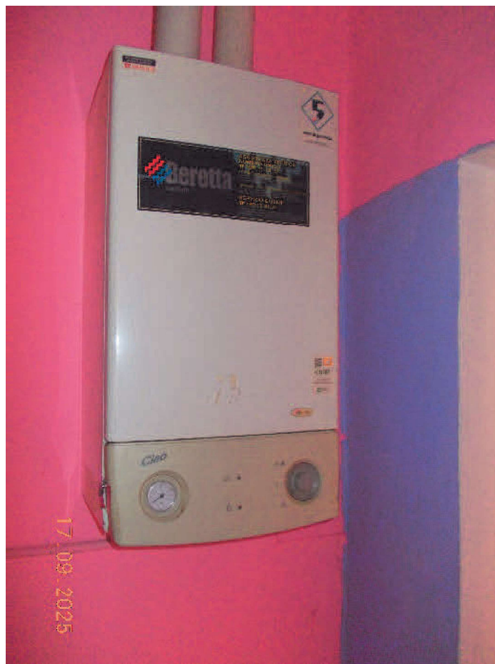
Caldaia in disimpegno piano terra
