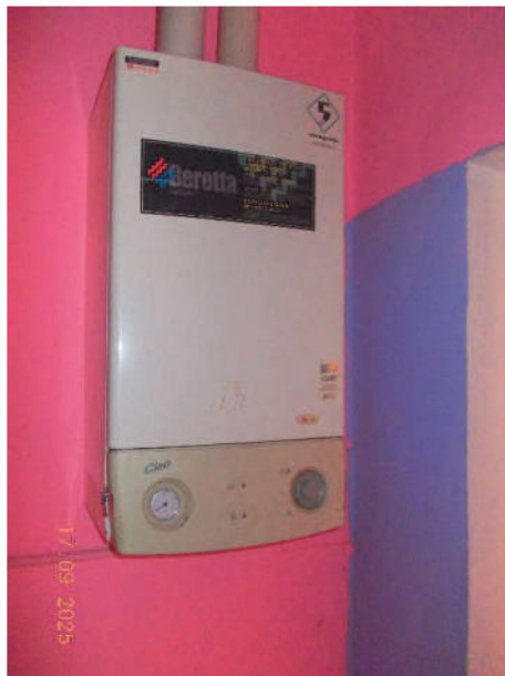
Caldia in disimpegno piano terra
