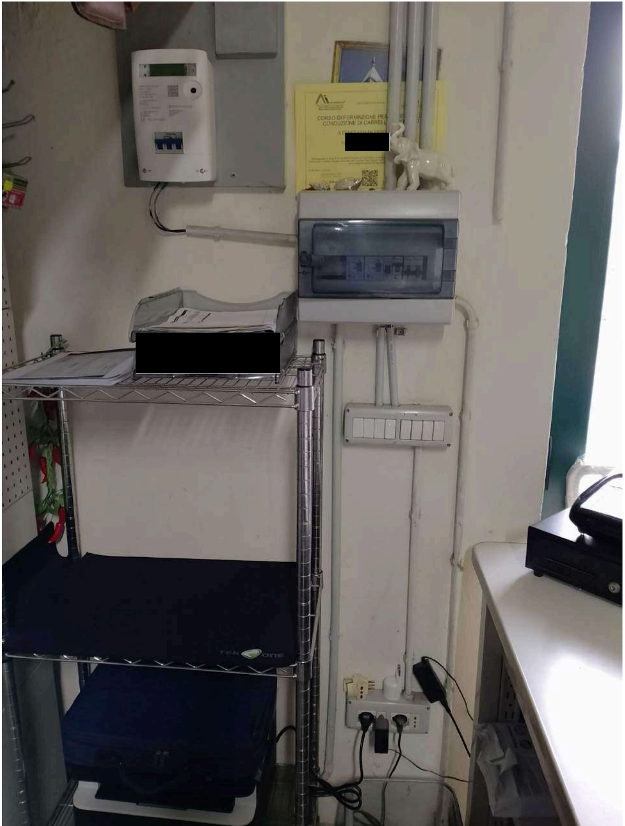
Foto 17 - Vista interna – centralino impianto elettrico
