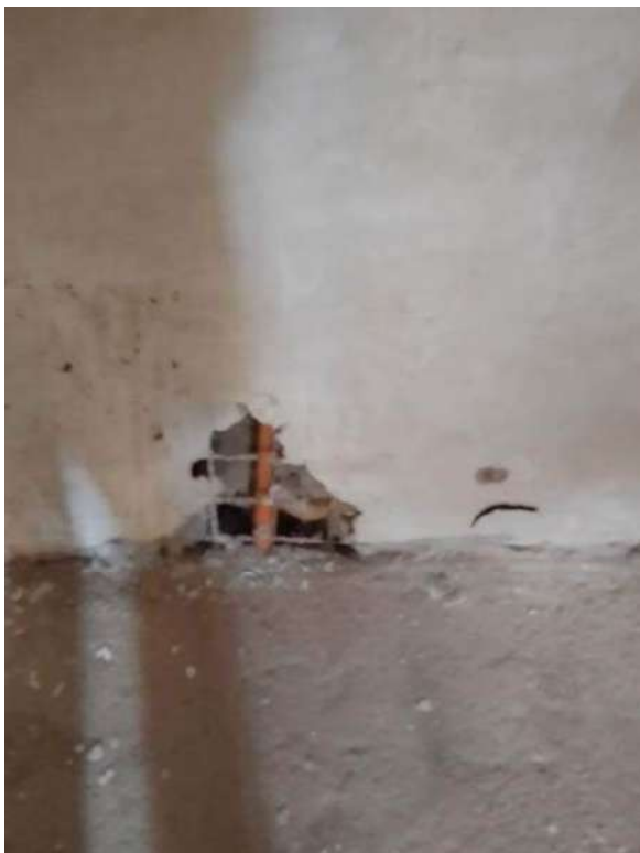
Foto 138, 139, 140 – Vista Interna – ammaloramenti
