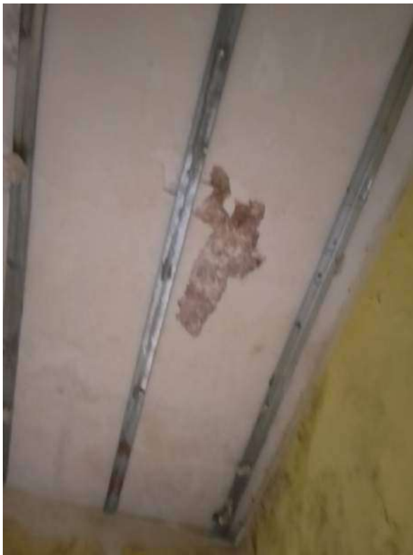
Foto 95, 96, 97 – Vista Interna – infiltrazioni
