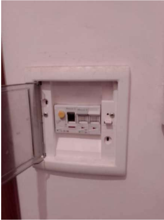
Foto 72, 73, 74 – Vista Interna – impianti
