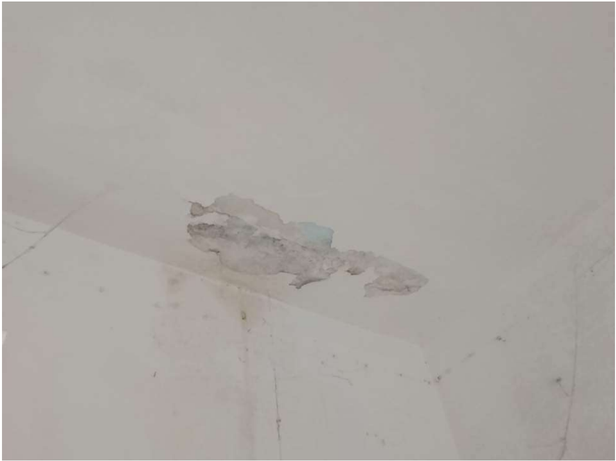
Foto 35 – Vista interna - infiltrazioni
