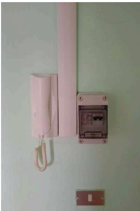
Foto 91, 92, 93 – Vista Interna – impianti
