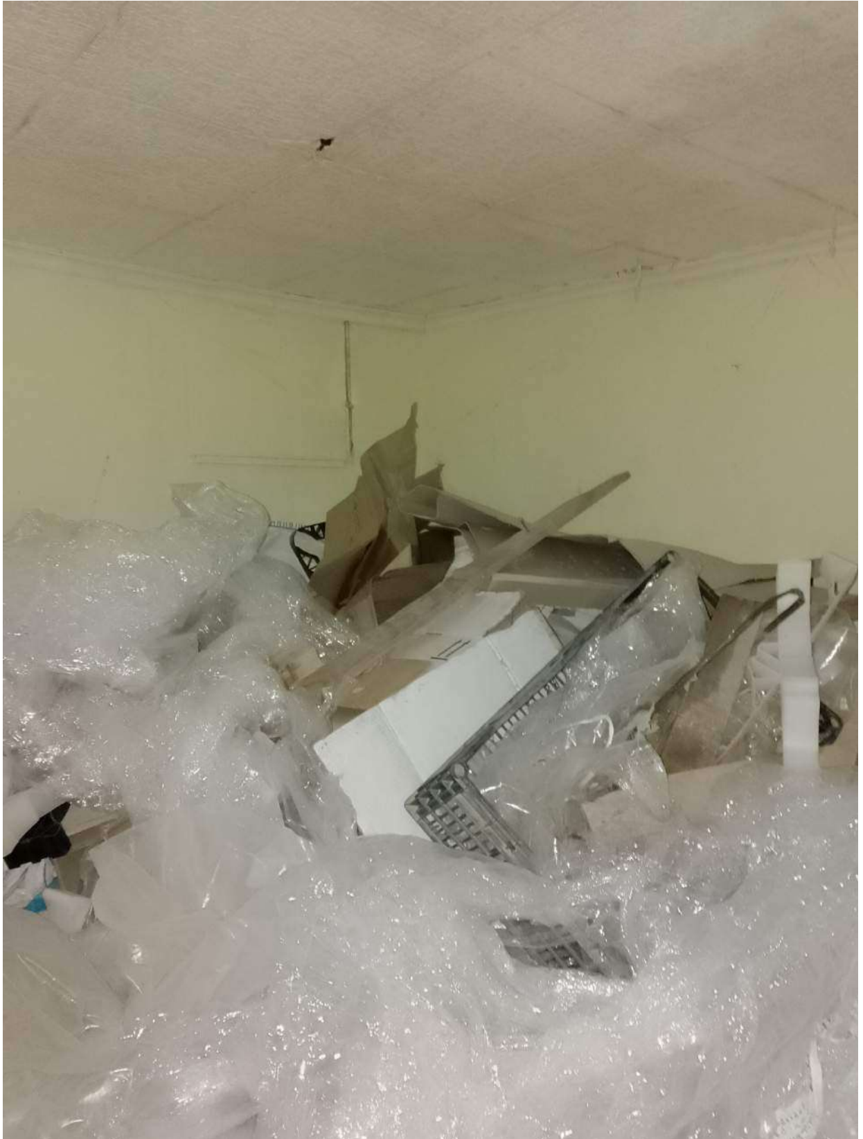
Foto 34 – Vista interna - infiltrazioni
