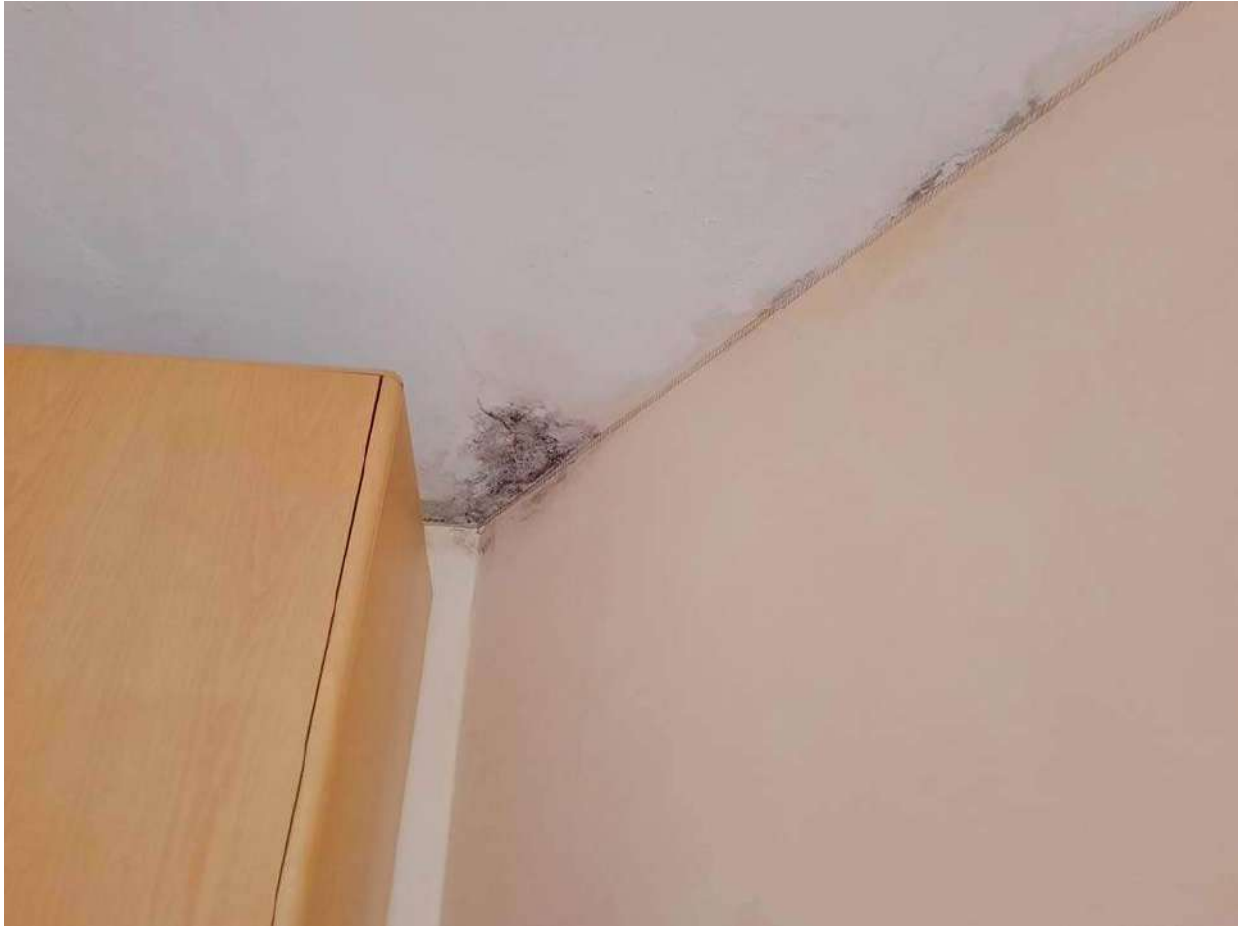
Foto 130 – Vista Interna – infiltrazioni
