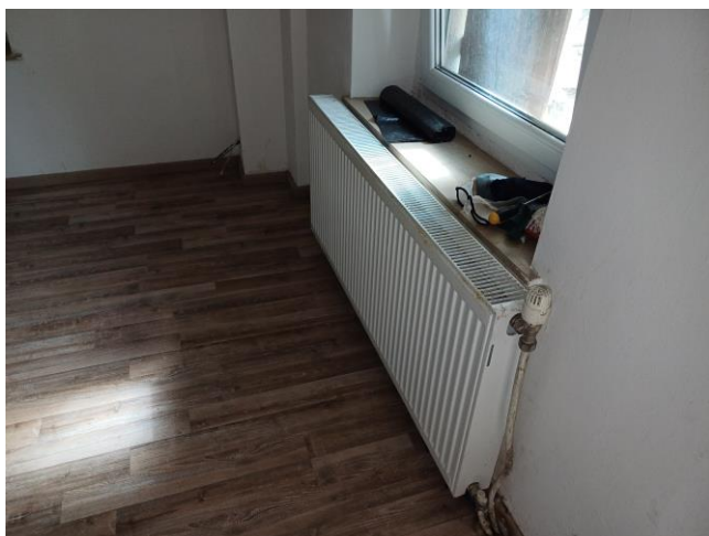
Radiatore in soggiorno
