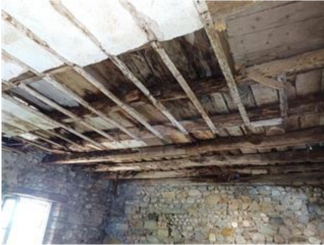
Stato del solaio annesso rustico
