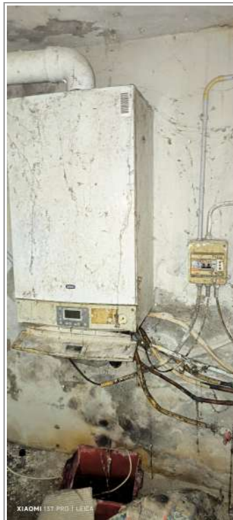
Foto n.27-28 :locaie tecnico e caldaia al PT
