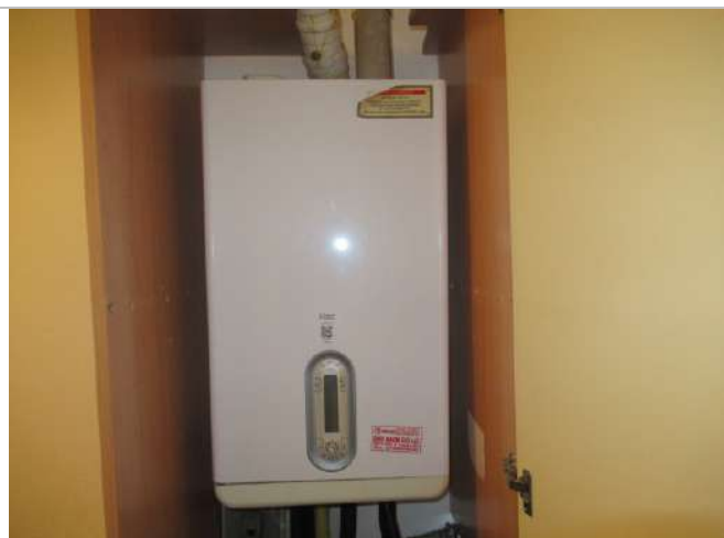
Foto n. 37: Sub. 15 - Soffitta / Caldaia murale
