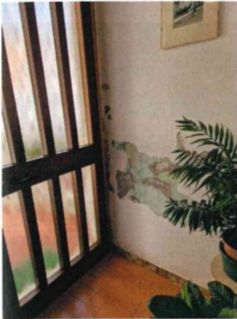
Foto 3: vista dell'ingresso; si nota il distacco dell'intonaco
