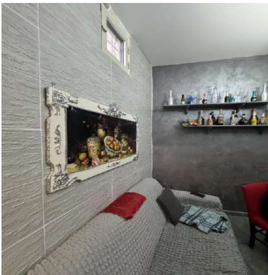
Foto n.15 – Parete del salotto rivestita a causa di infiltrazioni esterne
