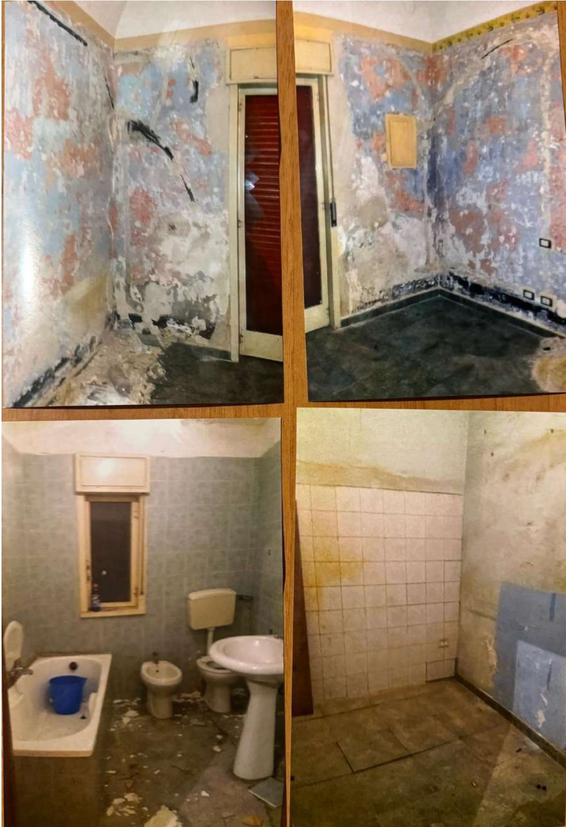
Foto 17-20 - Foto fornite dall'occupante che documentano lo stato dell'immobile prima dei lavori di ristrutturazione effettuati dagli stessi
