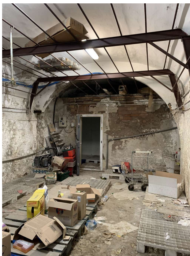
Foto n. 14 – Vista locale 4 con cella frigorifera
