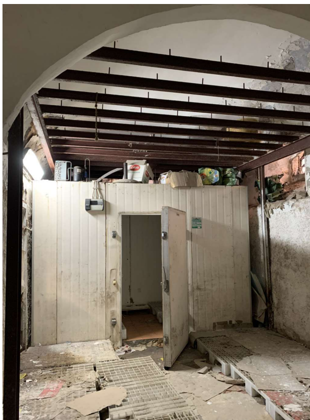
Foto n. 15 – Vista locale 5 con cella frigorifera
