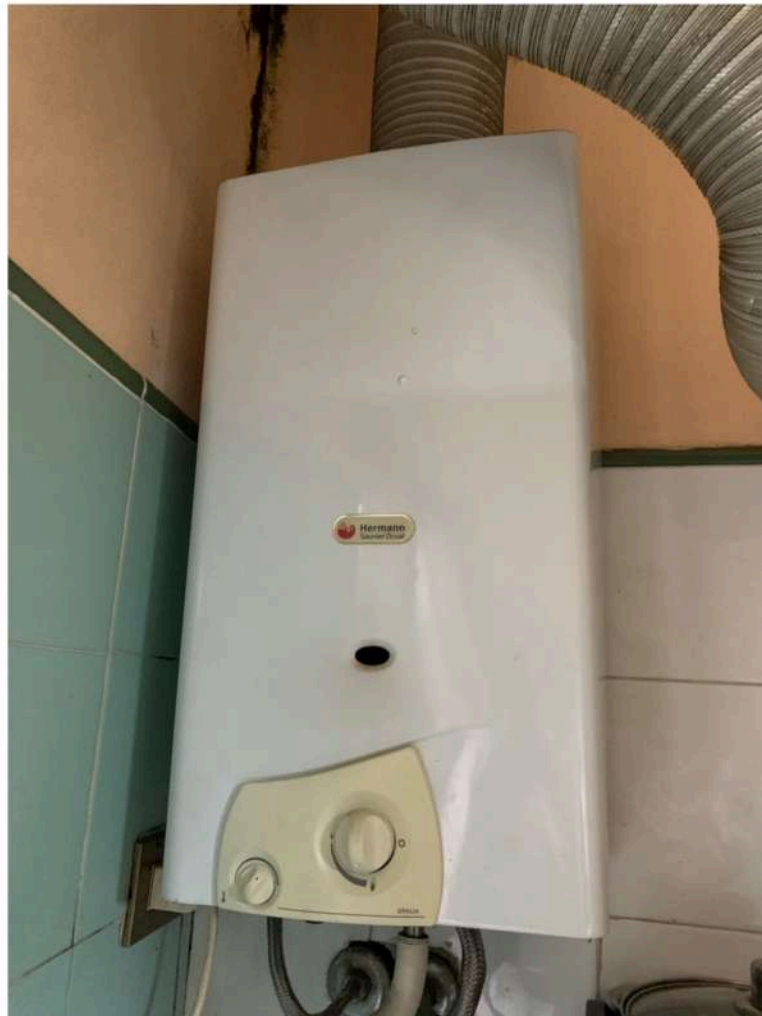
15 - Scaldacqua a gas sito in cucina
