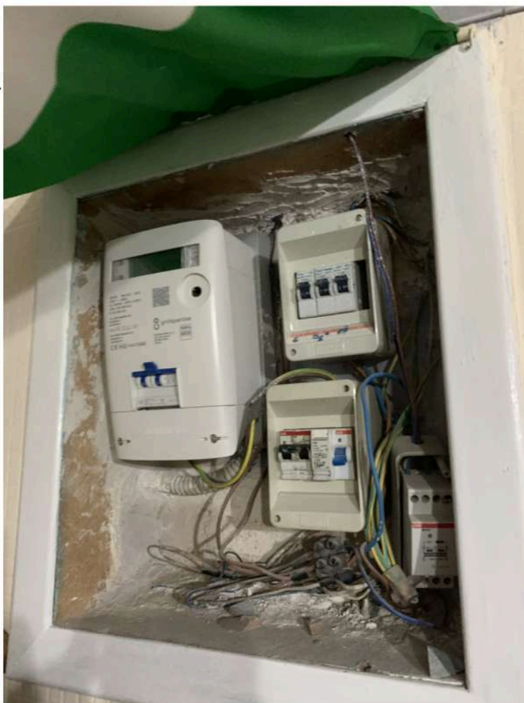
17 - Nicchia contatore energia elettrica
