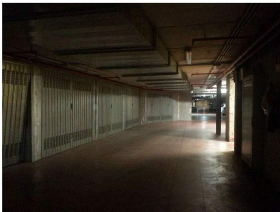
Figura 9: Canalizzazioni dell'impianto di ventilazione forzata.
