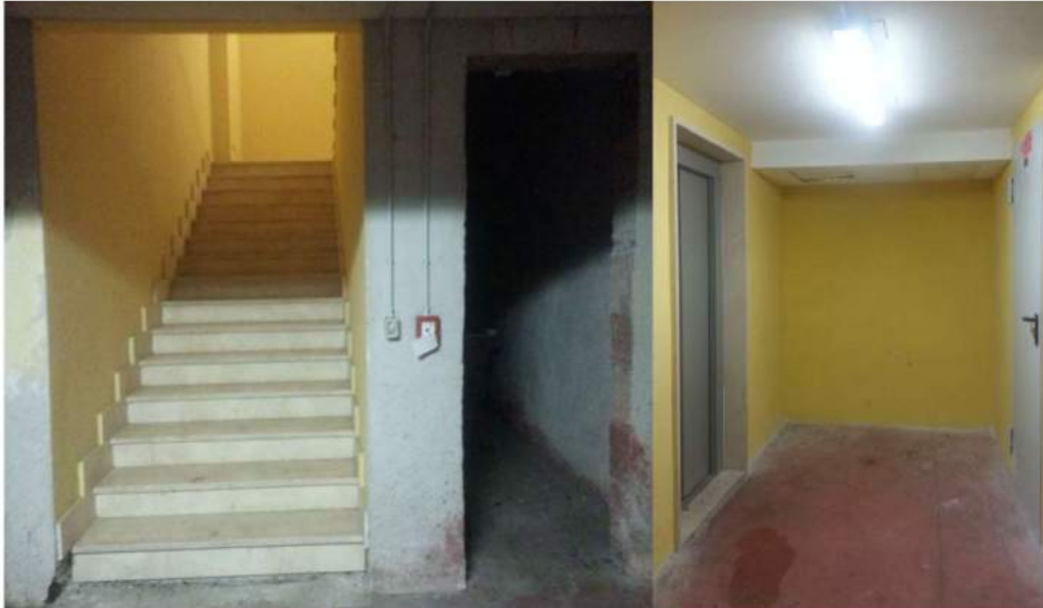
Figura 11: Assenza di zona filtro in prossimità di scale interne e vani ascensori.
