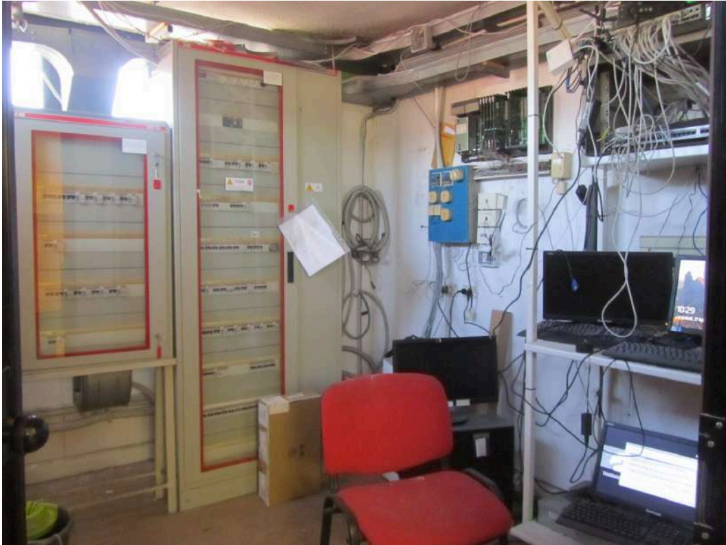
Foto n.63: Locale tecnico monitor
