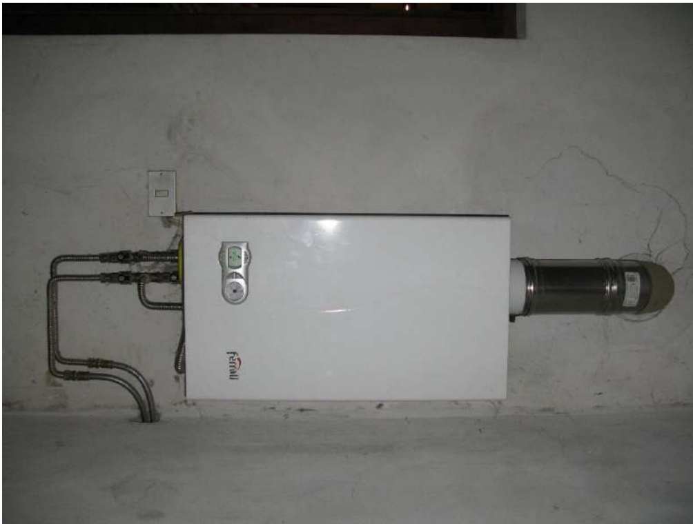
Foto n. 40: Caldaia sub 1 installata nel sub. 2 – Piano terra
