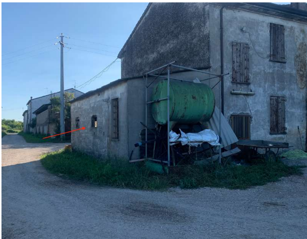
Porzione di edificio non autorizzata realizzato probabilmente in epoca più recente che andrà demolito
