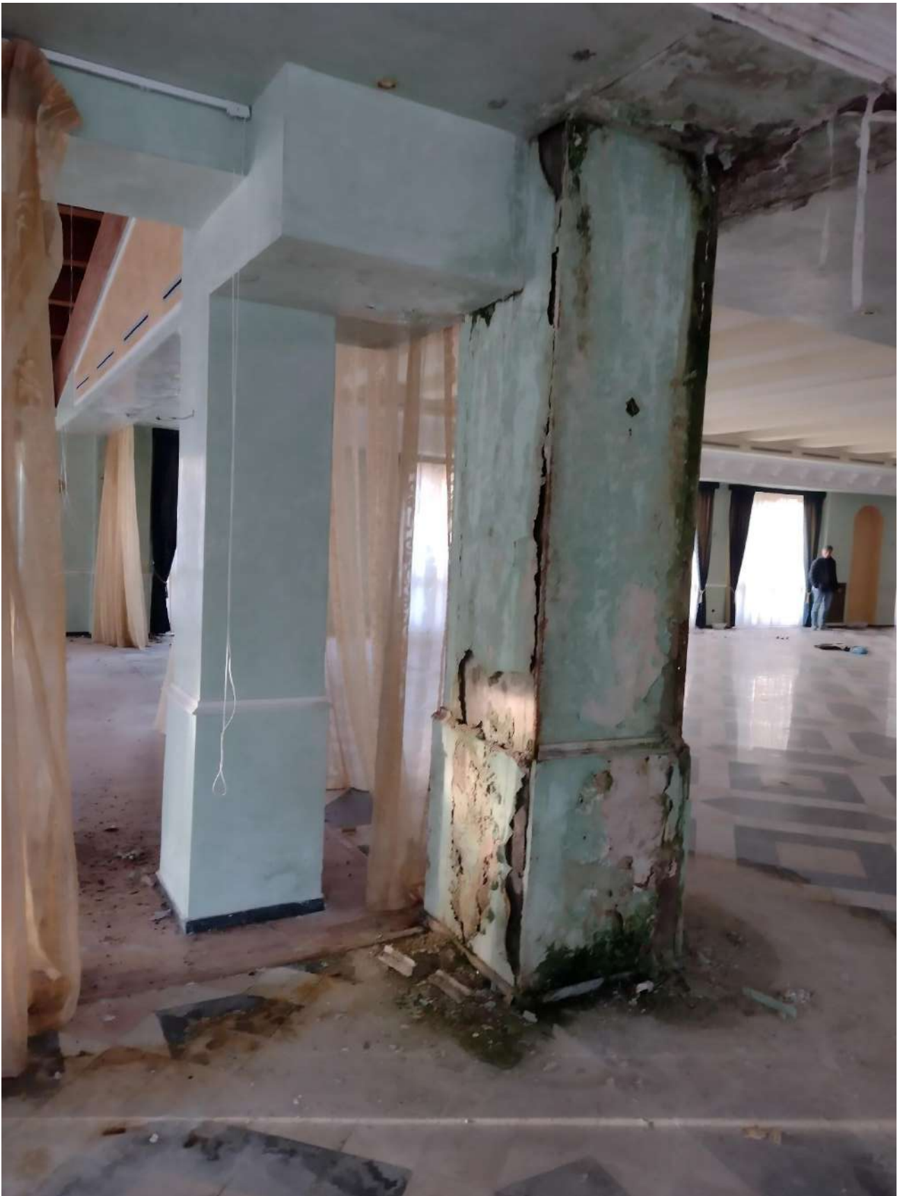
Figura 28. Lotto 1. Sala polifunzionale, area soggetta a infiltrazioni.
