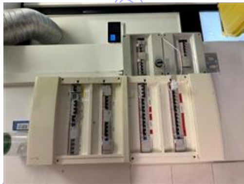
Immagine quadro elettrico
