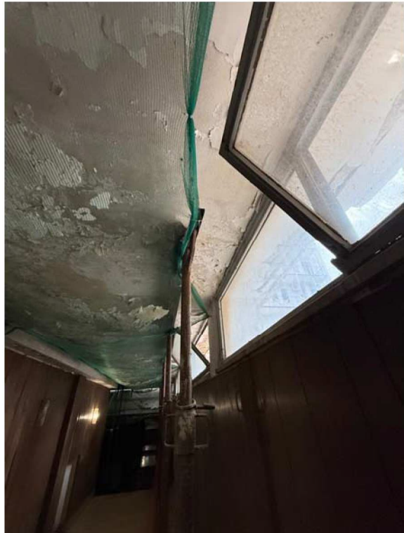
Danni sulle parti interne dell'androne condominiale
