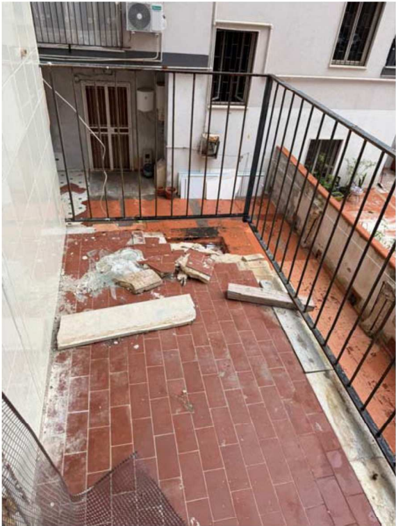
Porzioni di balcone crollate
