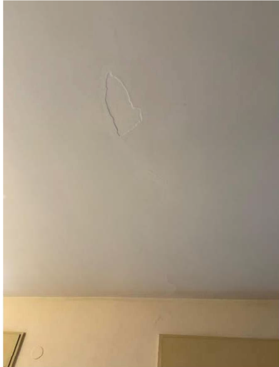
Danni sul soffitto corrispondente alla parete esterna
