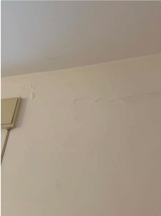
Lesioni sulla parete interna confinante con l'esterno
