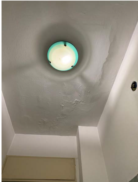
Ulteriore danno da infiltrazione subita dall'immobile al piano superiore
