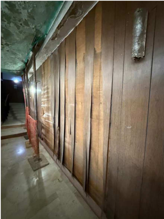
Danni sulle parti interne dell'androne condominiale
