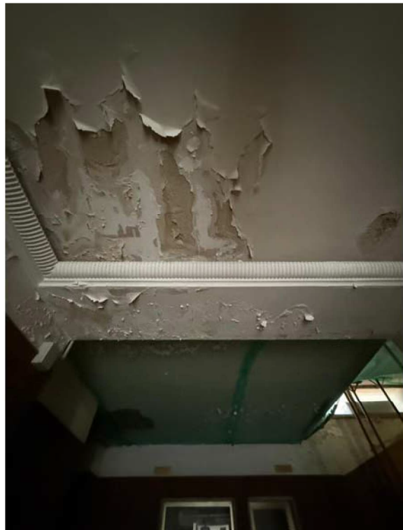
Danni sulle parti interne dell'androne condominiale
