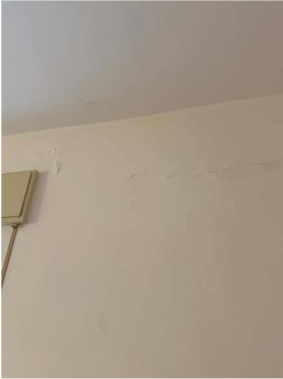
Lesioni sulla parete interna confinante con l'esterno
