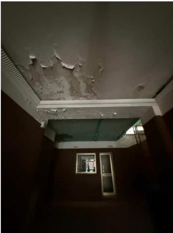
Danni sulle parti interne dell'androne condominiale
