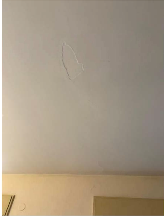
Danni sul soffitto corrispondente alla parete esterna
