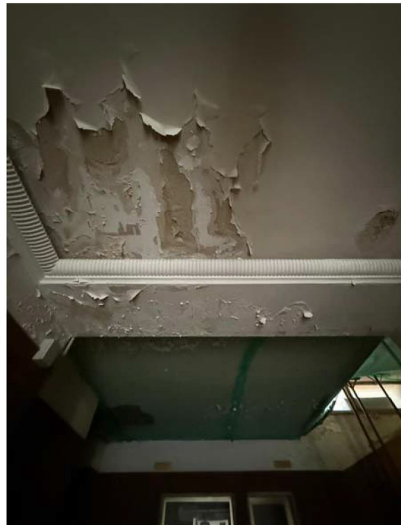
Danni sulle parti interne dell'androne condominiale
