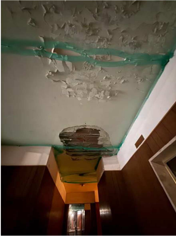
Danni sulle parti interne dell'androne condominiale
