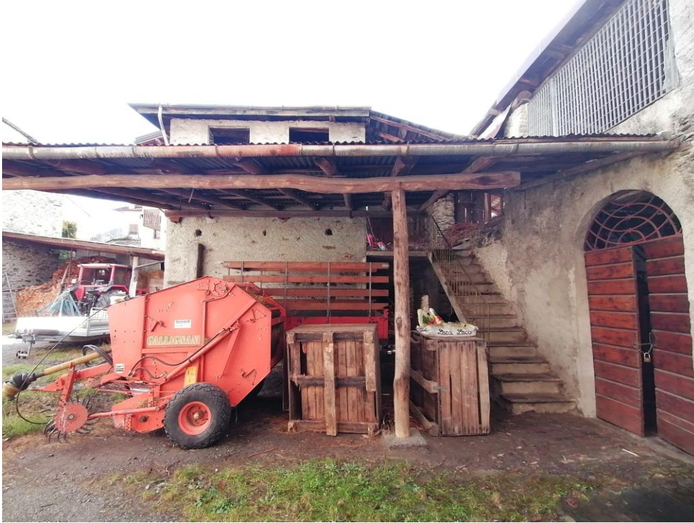
FOTO 5 – fabbricato 777 tettoia abusiva (LOTTO 2)
