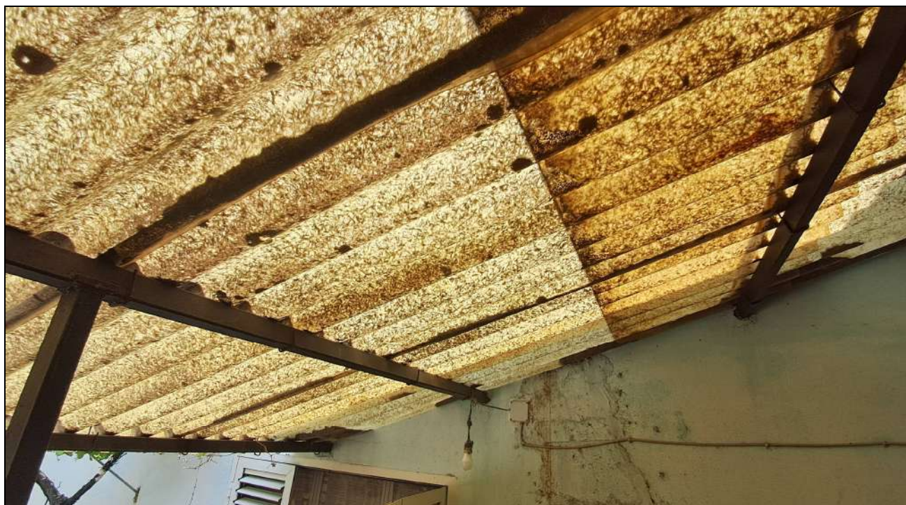
28. Tettoia scale – coperta abusivamente (ondulina in resina)
