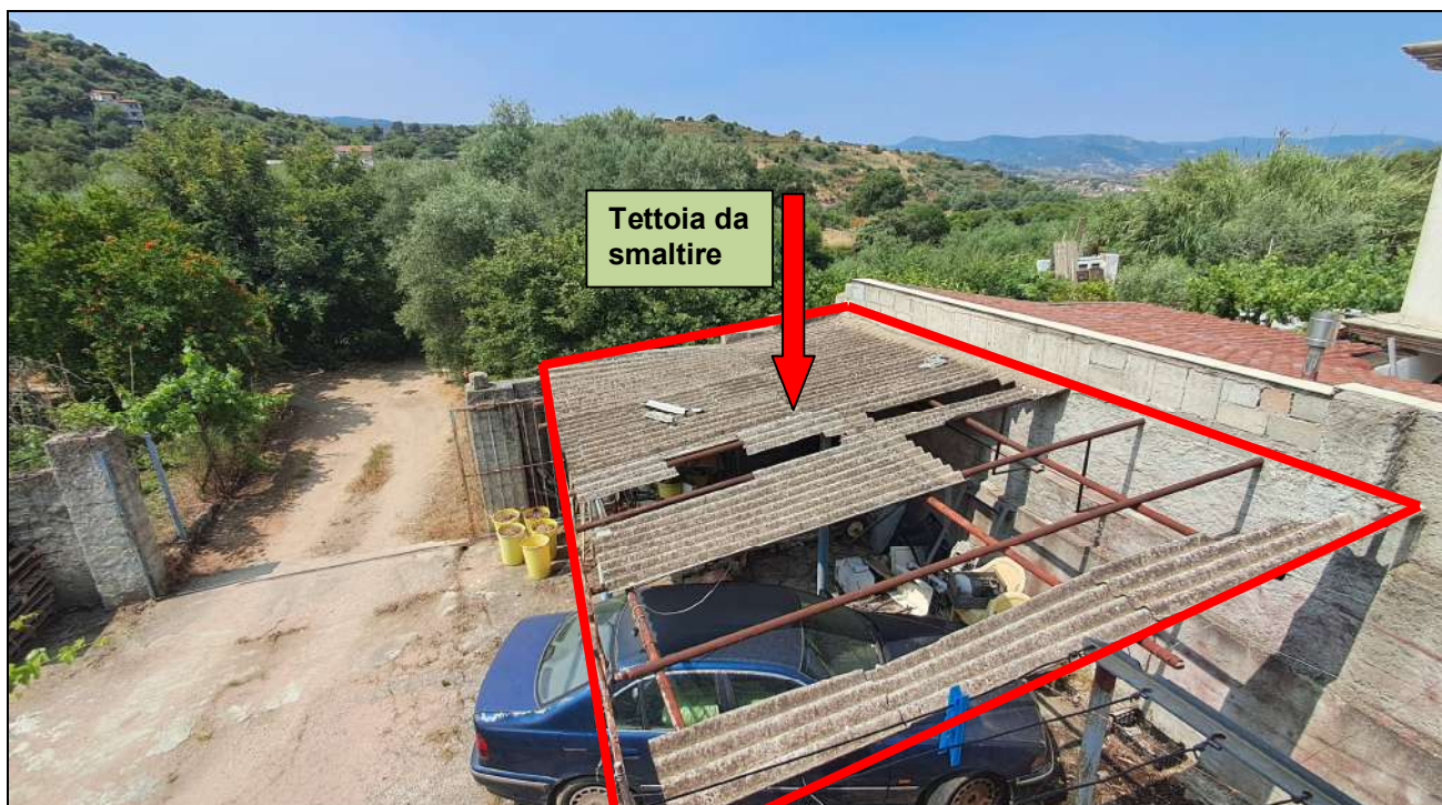
27. Vista cortile - Tettoia onduline - amianto
