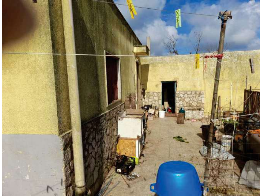
FOTO 5 – prospetto laterale est con vani abusivi
