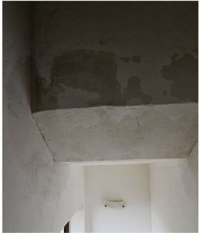
Fotografia delle macchie sull'intonaco
