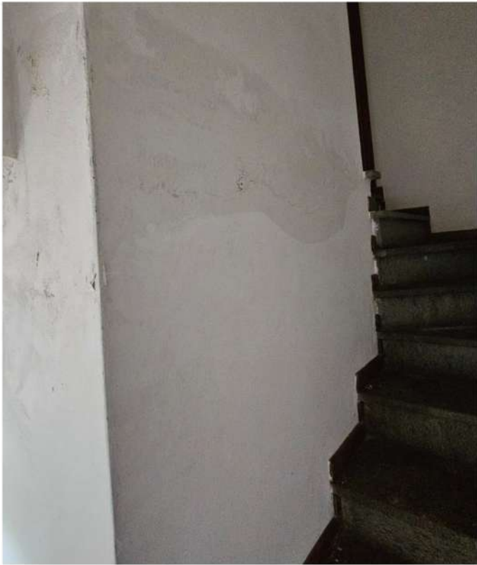
Fotografia delle macchie sull'intonaco
