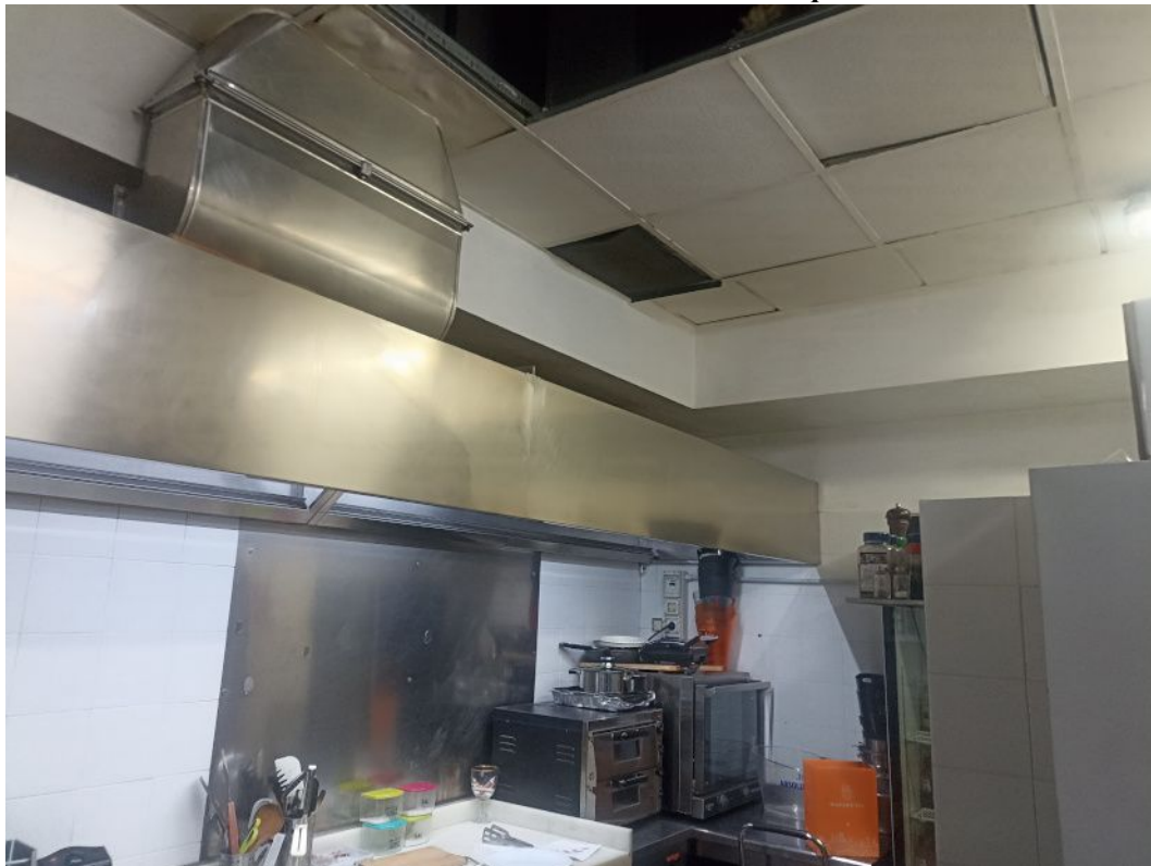
Foto 7 – controsoffitto dissestato in occasione del lucernaio dal quale ci sono infiltrazioni
