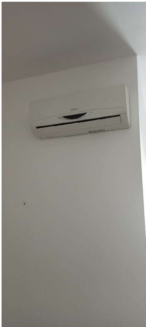
Foto 15: condizionatore abitazione lotto 2
