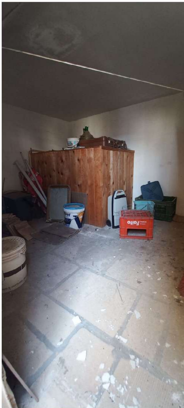
Foto 7: vano tecnico abitazione lotto 1
