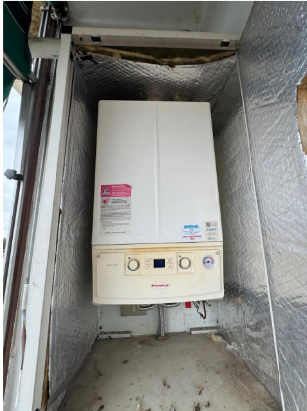
Foto 17. Stato attuale calderina
